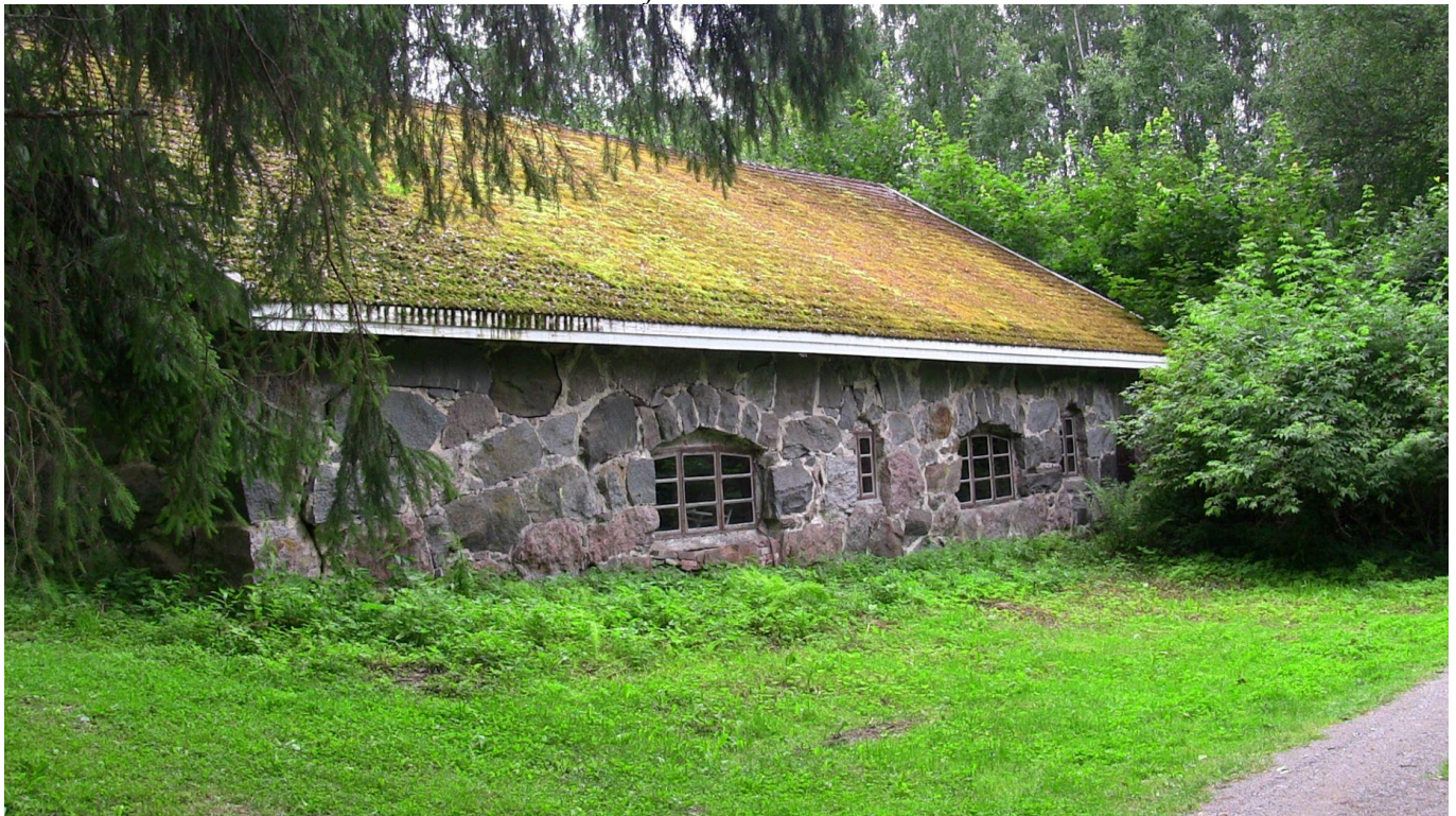
Asikkalan kotiseutumuseon kiviometan tiilikatto on kovin sammaloitunut. Kuva: Herkko Halme, Asikkalan kotiseutuyhdistys ry
