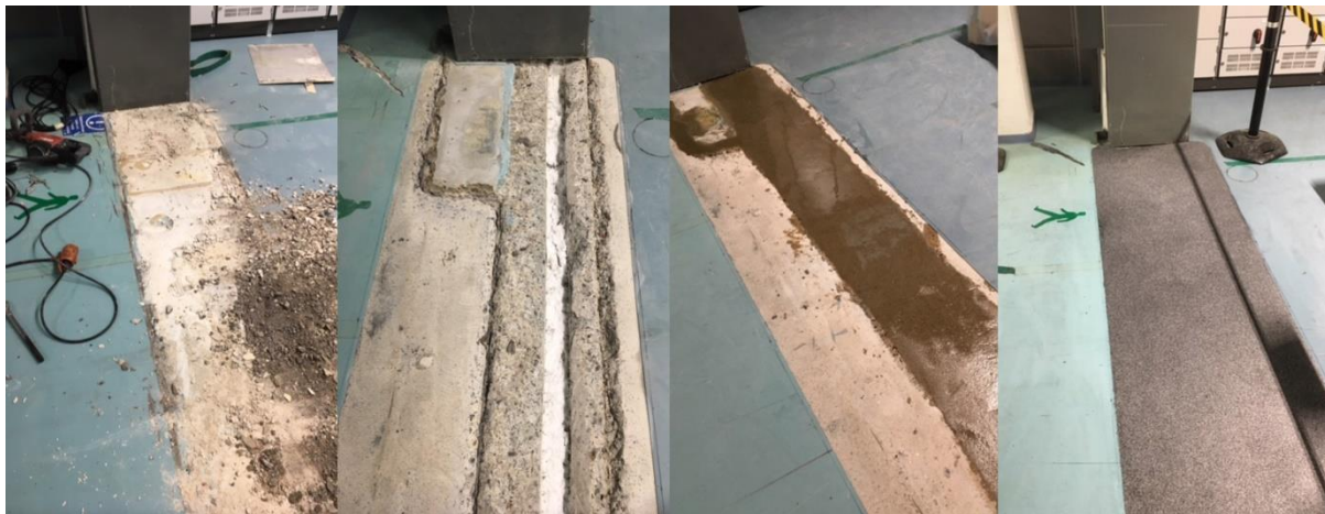
Kuva 73. Liikuntasauman pikakorjaus Pheron massalla. Vasemmalla kaksi ensimmäistä kuvaa: Alue valmisteltu Pheronin valamista varten. Kolmas kuva: Liikuntasauma peitetty Pheronilla. Neljäs kuva: Pheron STB:llä rakennettu luiska.
