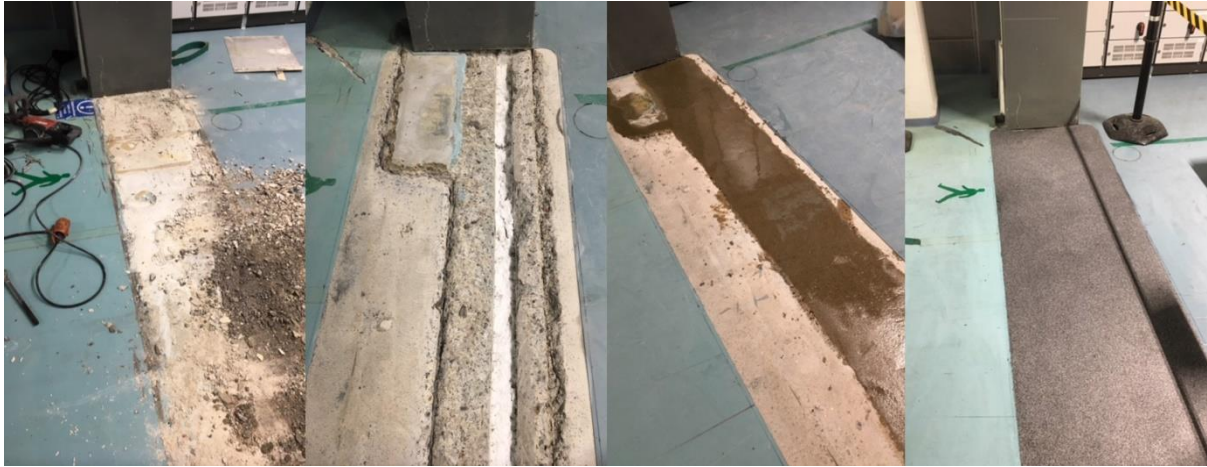
Kuva 73. Liikuntasauvan pikakorjaus Pheron massalla. Vasemmalla kaksi ensimmäistä kuvaa: Alue valmisteltu Pheronin valamista varten. Kolmas kuva: Liikuntasauva peitetty Pheronilla. Neljäs kuva: Pheron STB:llä rakennettu luiska.
