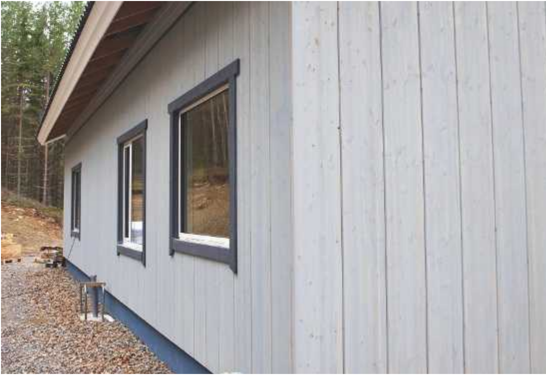
Padasjoelle keväällä valmistuvan vapaa-ajan asunnon seinät on koottu Baulog-elementeistä. Lievästi sinertävä väri on saatu aikaan sävytettyllä pintakäsittelyaineella.
