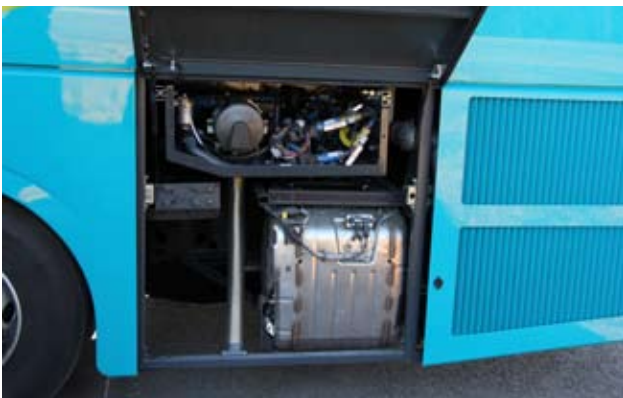
Lisälämmitin, Webasto tai Stroco, on äänenvaimentimen yläpuolella. Euro 6 moottori lämmittää kylmästä liikkeelle lähdeittäessä ensin moottorin vesikierron lämmitäkseen nopeasti. Lisälämmittimelle on käyttöä aina jäähtyneellä moottorilla lähdeittäessä.
