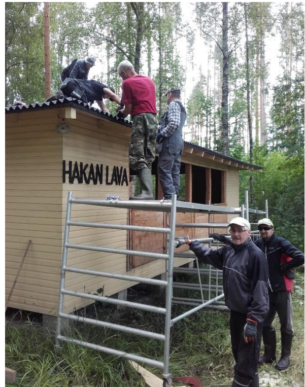
Hakan tanssilavan katto uusittiin aaltovuovilla joku vuosi sitten. Vesi ei enää tule läpi.
