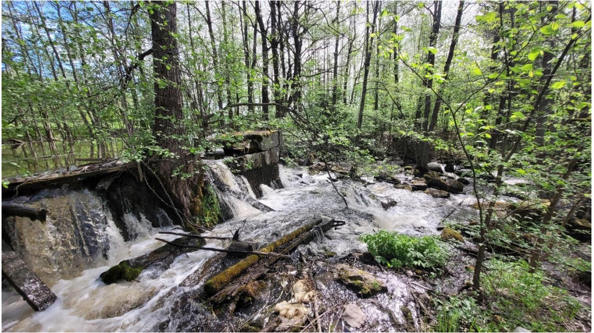
Kuva 9. Myllykosken padon länsipuoliset aukot sekä vuotovesiä 20.5.2024
