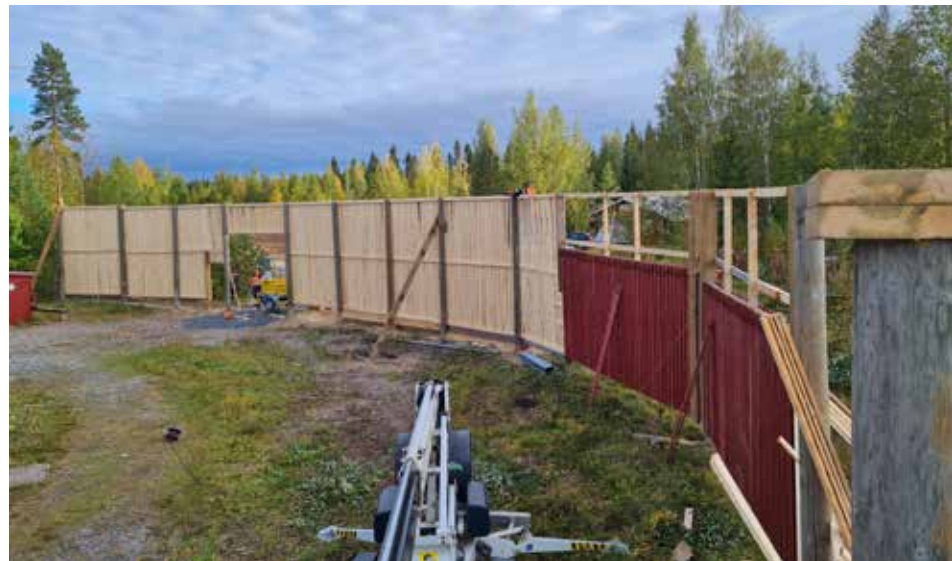
Perjantain ja lauantapäivän talkoiden lopputulos oli trapradan valmis meluaita, ja tässä näkyvän skeetradan rakenteiden viimeistely tehtiin sunnuntaina. Enää maalausta ja tukiharusten asennusta vaille valmis työ, projektin aikataulus toimii. Kuva: Sami Pokki
