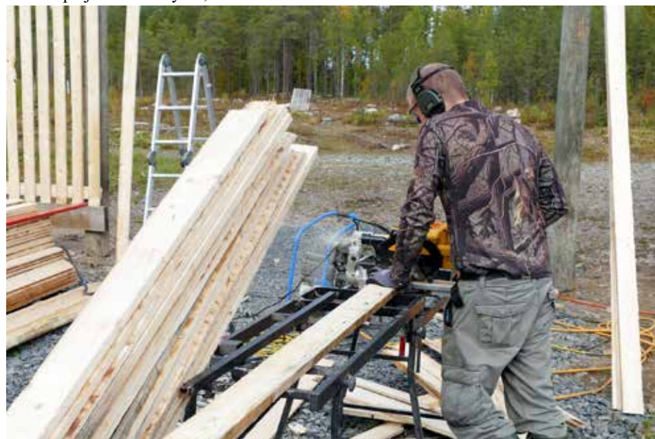
Oulusta viikonlopuksi vanhalle kotipaikalleen saapunut, riista- ja hirvimieheksi tunnustautunut, Olli-Heikki H. sirkkelöi mittatarkkaa lautaa valmiiksi työparille, joka sitten naulasi ne aikaisemmin pystytettyihin tukikehiköihin. Kuva: Jouko Liikanen
