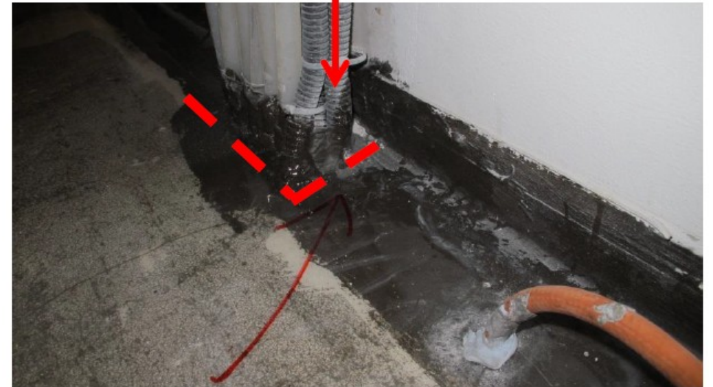
Putkien läpivientikohdassa havaittiin nauhamainen ilmavuoto
