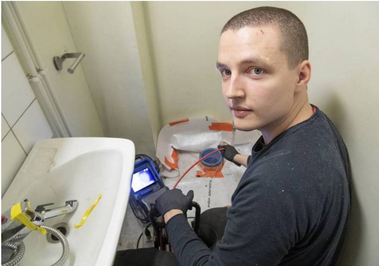
Salolaisissa kiinteistöissä on paljon vanhoja viemäriputkia, jotka pitäisi saneerata lähivuosina. Viemäriputkien sukistusta tehdään parhaillaan muun muassa Märynummella, Asunto Oy Hirvisadossa. NF Sukitus Oy:n Oliver Lietzén dokumentoi työn tulosta viemärikameralla. Kuva: SSS/Minna Määttänen
