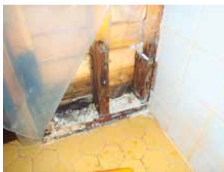
Laatoitetun seinän takaa löytynyt vesivaurio.
