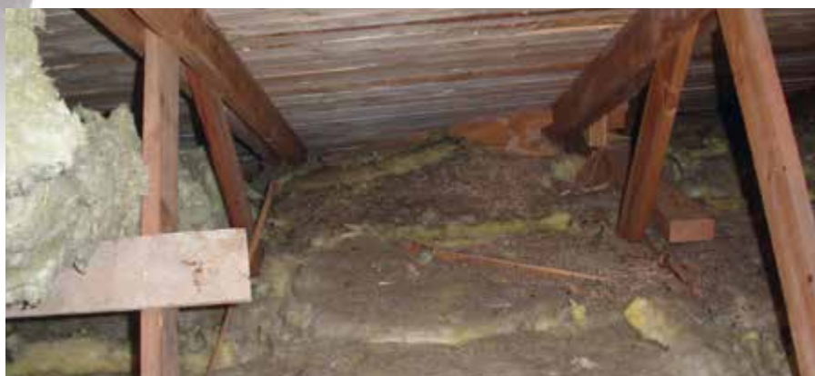
Räystään tuuletusrako on tukittu lisäeristämisen yhteydessä.
