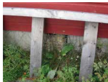
Alapohjan tuuletusaukkoja ei saa tukkia.
