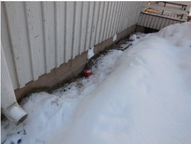
Alapohjan tuuletusluukut on tukittu.
