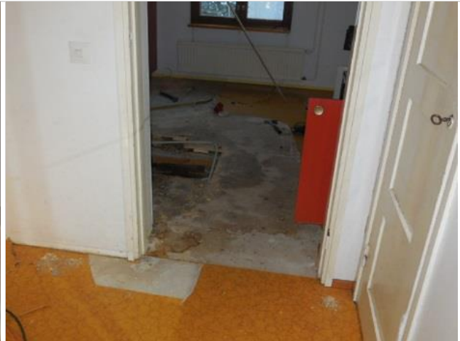
Kuva eteisestä keittiöön. Eteisen ovenpielessä lastulevy oli kostea.
