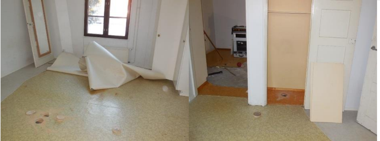
Makuuhuoneessa vettä oli muovimattojen välissä ja lastulevyyn yläpinta oli kostea. Lastulevyssä ei ollut tummentumaa. Vaatekaapissa lattian eriste oli kosteusvaurioitunut.
