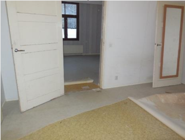
Kuva makuuhuoneesta olohuoneen ovelle. Olohuoneessa ei ollut enää kosteutta muovimaton alla
