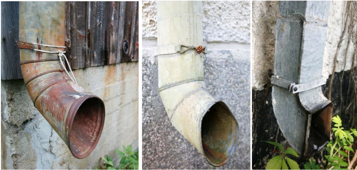
Kuvat 1, 2 ja 3. Syksytorvien torvimaisia ulosheittäjiä. Keskimmaisessä syöksyssä pystysaumaa on asennettu ulkopintaan, joka helpottaa saumojen huoltoa. Taidokkaasti kantattu neliötorvi Sulkavan vanhainkodilta, arkkitehti Axel Mörne.
