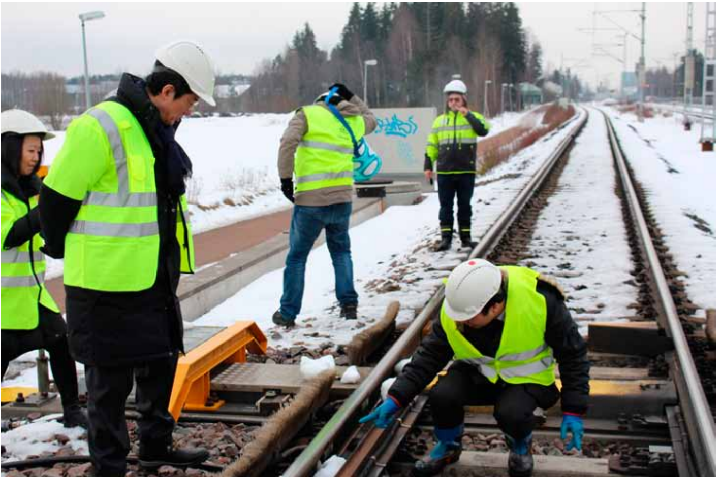
Japanin Suomen suurlähettiläs Kenji Shinoda (toinen vasemmalta) tutustumassa laitteistoon Havukoskella Kehäradan erkanemispaikassa 13.2.2015. Kielen ja tukikiskon väliin on koetarkoituksessa pudotettu lunta ja jäätä.
