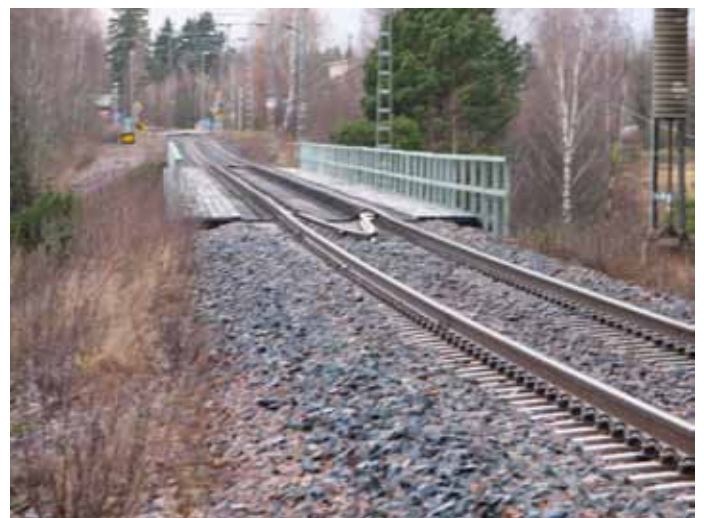
Kuva 5. Sillan kisko ja länsipään taustan painuma sillan ja tasoristykseen välillä.
