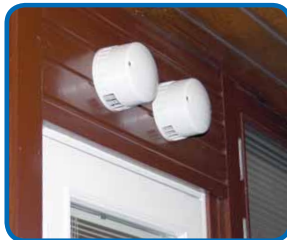
Kuvassa: Lossnayn ilmansyöttö- ja poisto-putkien sääsuojat (näkyvä ulkoseinustalla)
