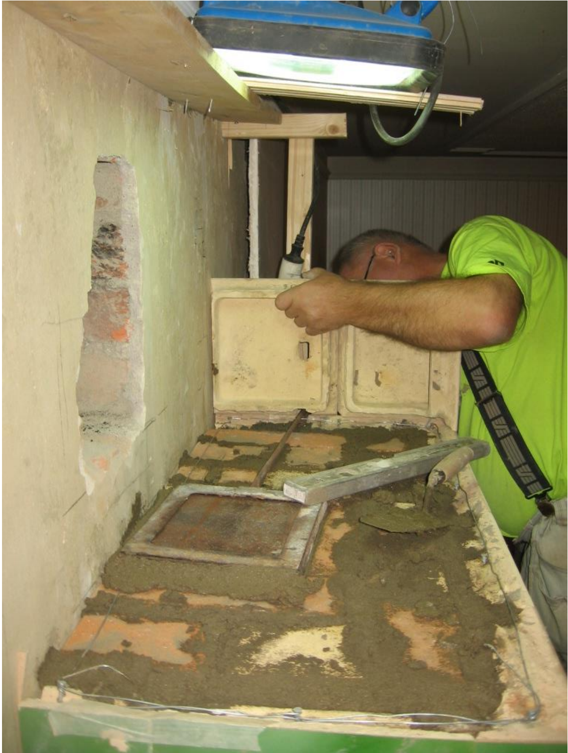
Kuva 80 Kun pellin varren kohdalla oleva kaakeli on muurattu paikoilleen, ei peltiä voi enää uunista poistaa kaakelia irrottamatta.
