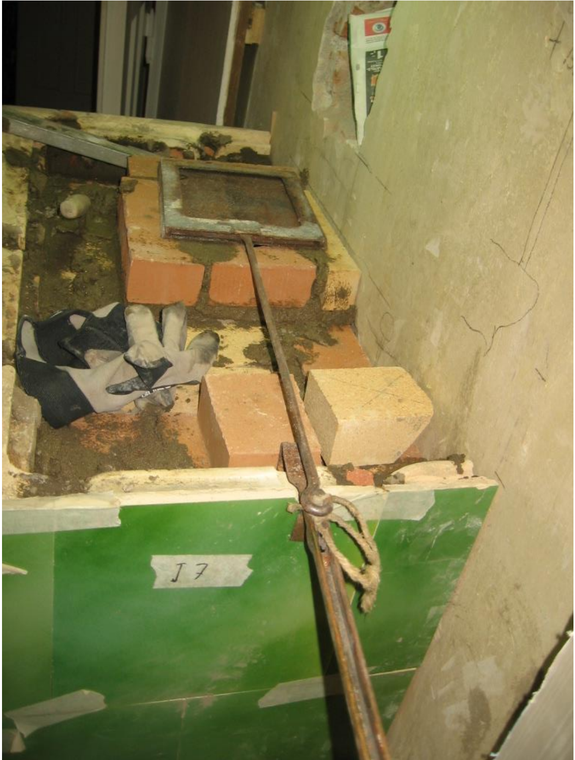
Kuva 76 Mitoitus ja säädöt ovat kunnossa, joten pelti osuu kehikkoon ja mahtuu avautumaan sekä sulkeutumaan kokonaisuudessaan.
