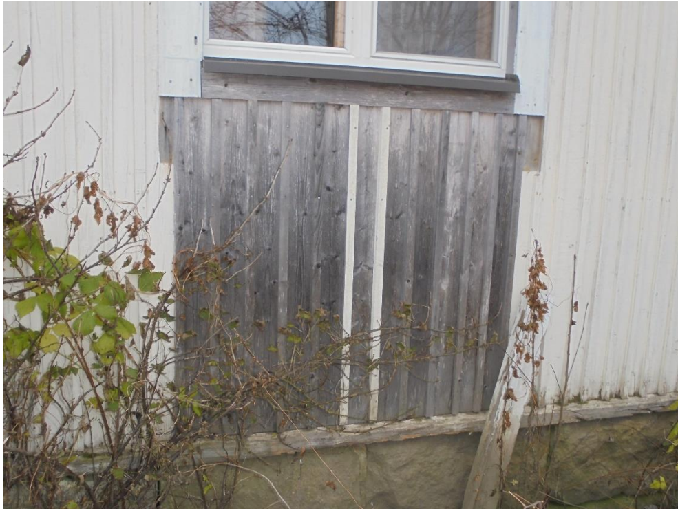
Kuva 17 Puutteelliset pellitykset ja ikkunoiden oleminen syvennyksessä on todennäköisesti vaurioittanut osittain ikkunoiden alapuolella olevia hirssiä. Hirret on helppo paikata tai jopa vaihtaa myös ulkokautta.
