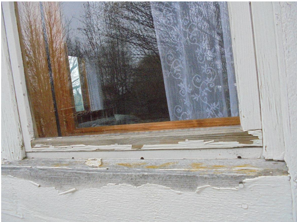
Kuva 42 Eteläpäädyn ikkunoissa ei ole suojapellityksiä. Ikkunat ovat puuikkunoita, joissa on maalipinnan irtoamista ja puupinnan nukkaantumista. Lasit on kiinnitetty paikoilleen pellavaöljykitin sijaan kittilistoilla, jotka eivät ole yhtä hyvä ja tiivis kiinnitystapa.
