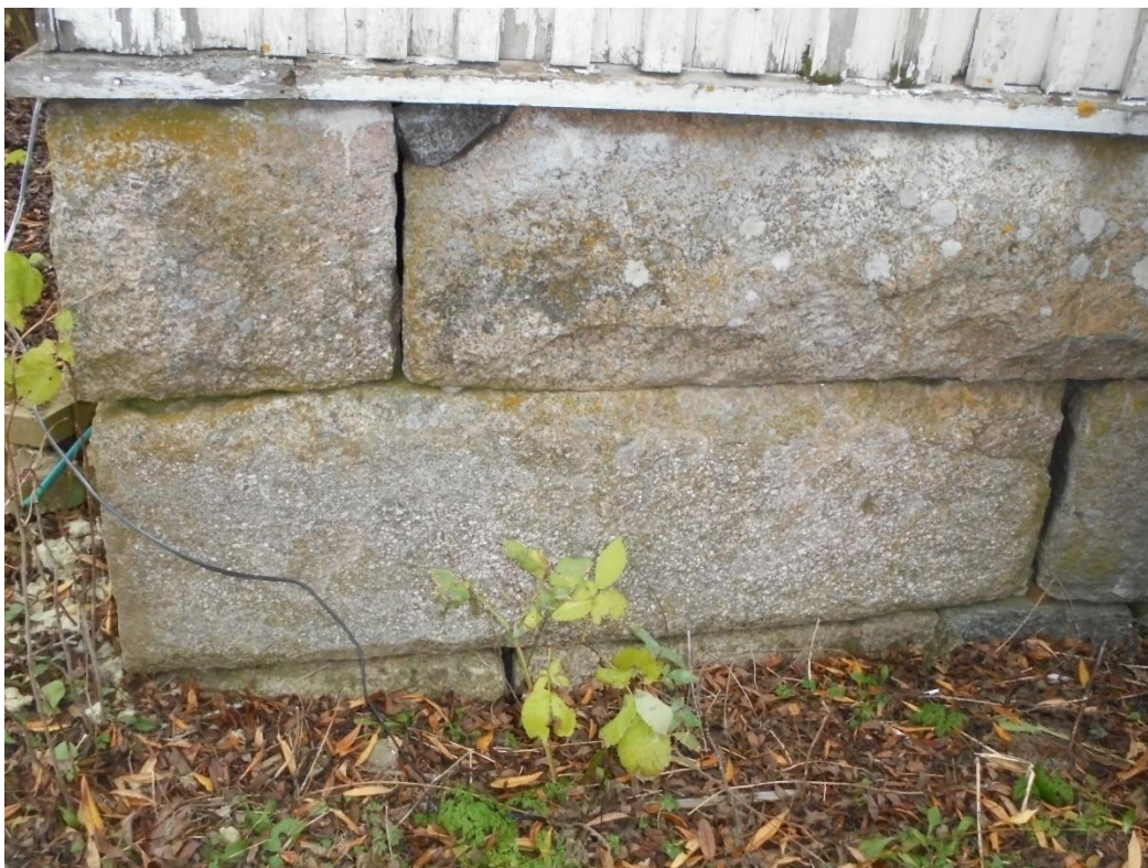
Kuva 10 Kivien välisiä saumoja ei ole tiivistetty laastilla rakentamisen yhteydessä.
