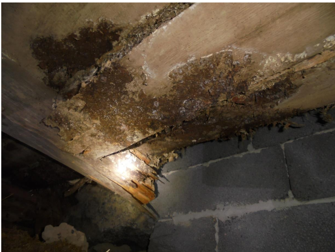
Kuva 28 Rakenteisiin on jätetty kuivunutta lahottajasienikasvustoa.
