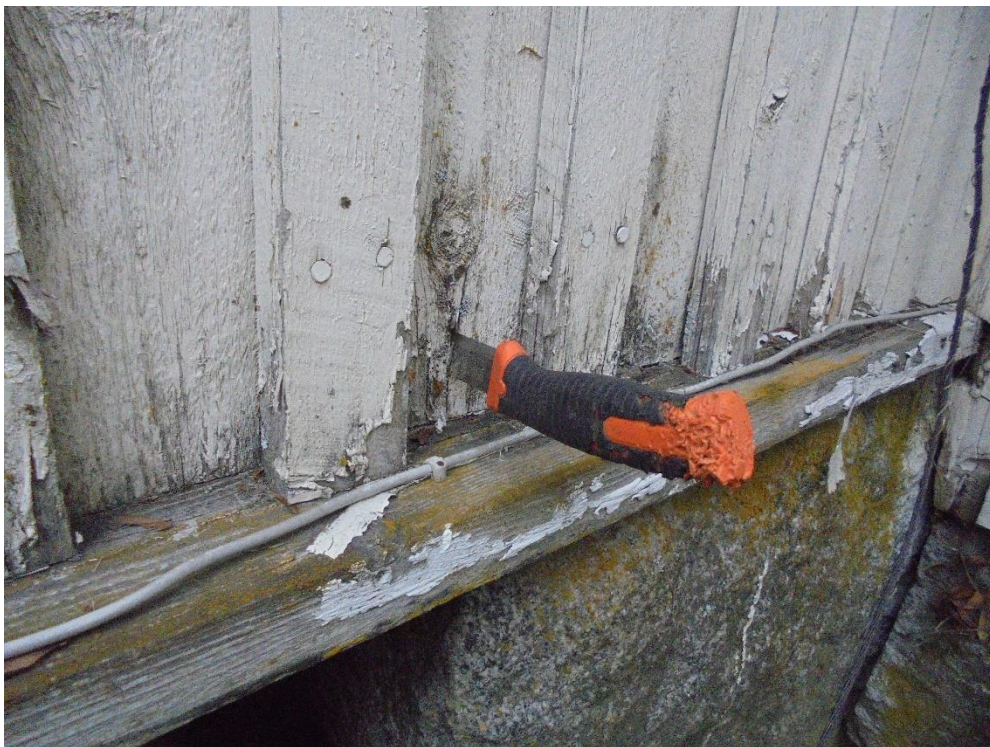
Kuva 18 Kuistin vesikatto on ohjannut vettä osittain ulkovuorausta päin, jolloin myös hirteen on muodostunut pintalaho. Pintalaho on korjattavissa korvaamalla hirren lahonnut pinta lankusta tehtävällä paikkapalalla.
