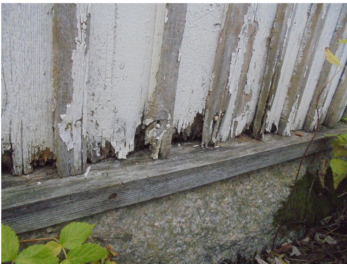
Kuva 21 Ulkovuoren alahelmassa on vaurioita takapihan alkuperäisessä ulkovuorauksessa sekä muiden julkisivujen uudemmissa ulkovuorauksissa.
