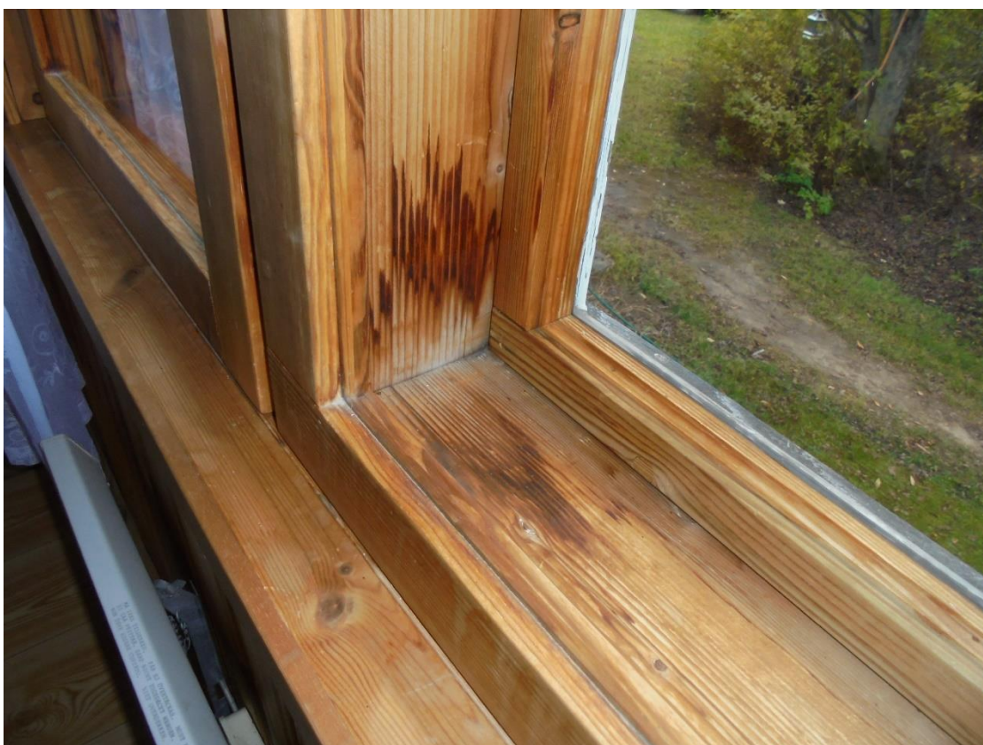
Kuva 43 Vanhemmissa ikkunoissa on merkkejä kondenssikosteudesta. Ikkunat ovat kunnostettavissa maalaamalla, jolloin niistä saadaan pienillä kustannuksilla siistit.
