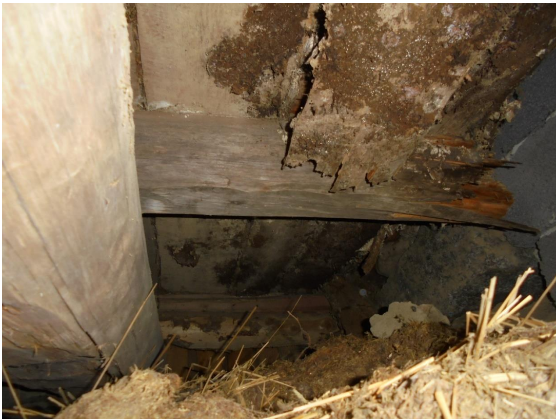
Kuva 27 Alapohjaa ei ole korjattu kunnolla kunnostustöiden yhteydessä.
