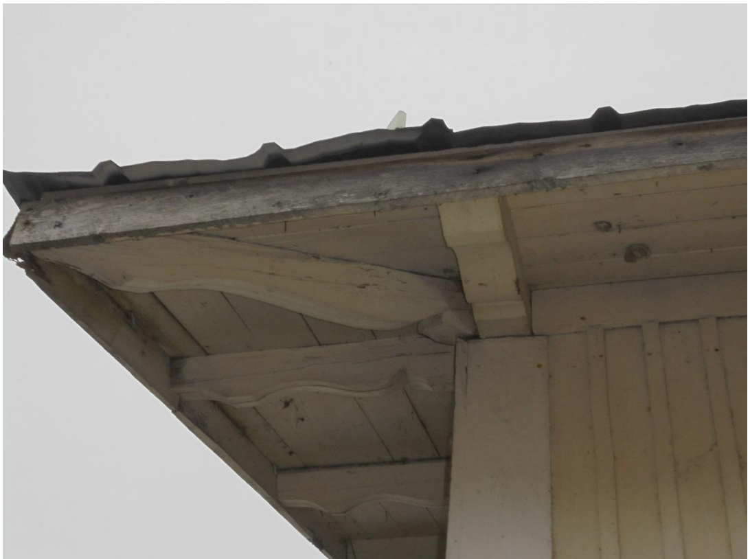
Kuva 8 Vesikatteen vaihtamisen yhteydessä räystäälle ei ole asennettu vesikouruja.
