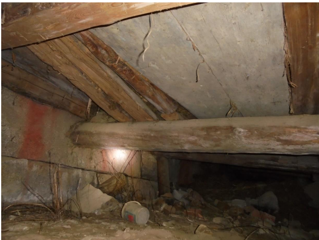
Kuva 31 Puisten pystytukien kaatuessa niskat ovat päässeet putoamaan paikoiltaan.
