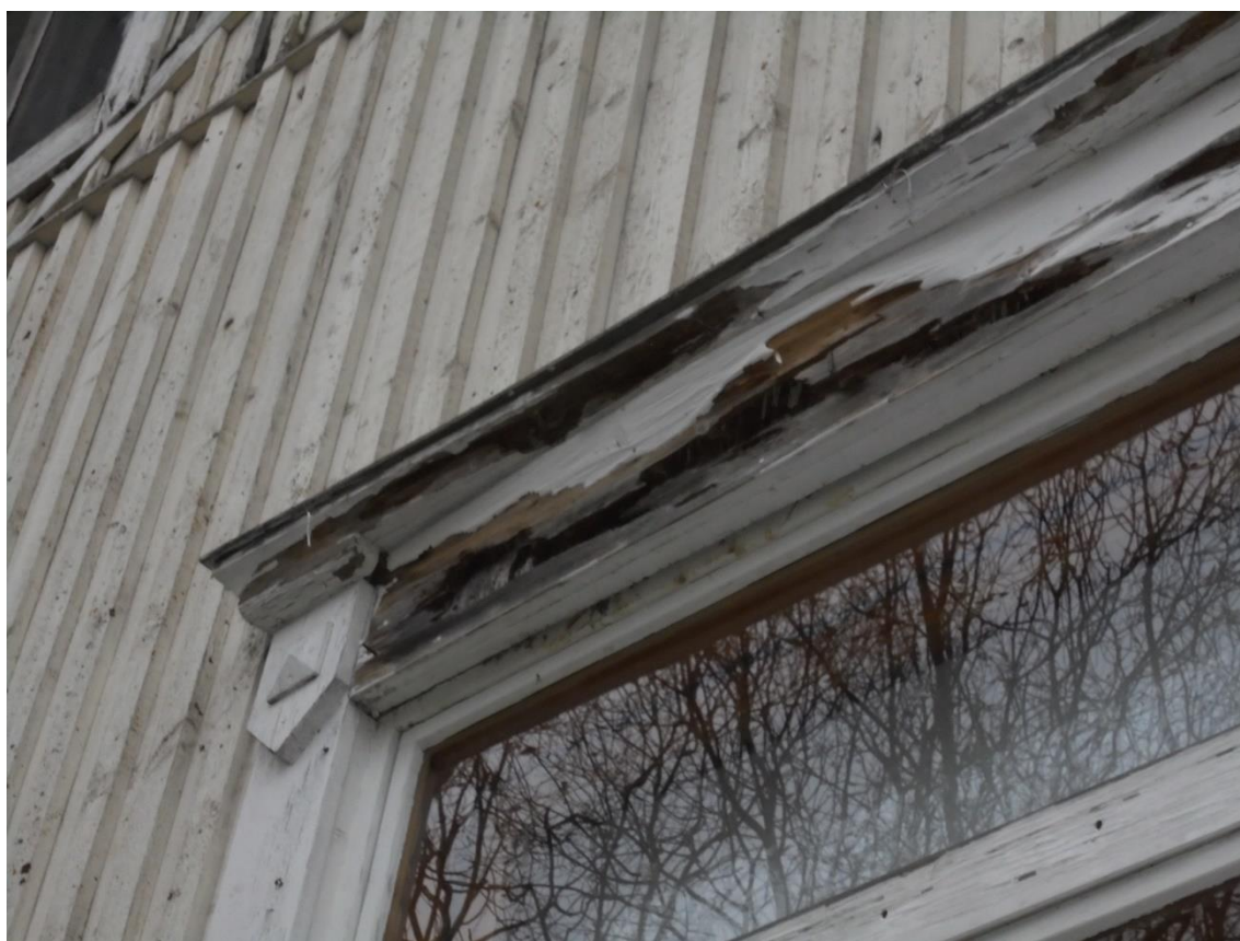
Kuva 22 vettä on kulkeutunut ikkunan vuorilaudoituksen taakse, josta kosteus ei kuivu kyllin nopeasti pois. Tällöin syntyy lahovaurio vuorilaudoitukseen ja ulkovuoraukseen. Korjaamisen yhteydessä tarkastetaan hirsirungon kunto ikkunan yläpuolelta.
