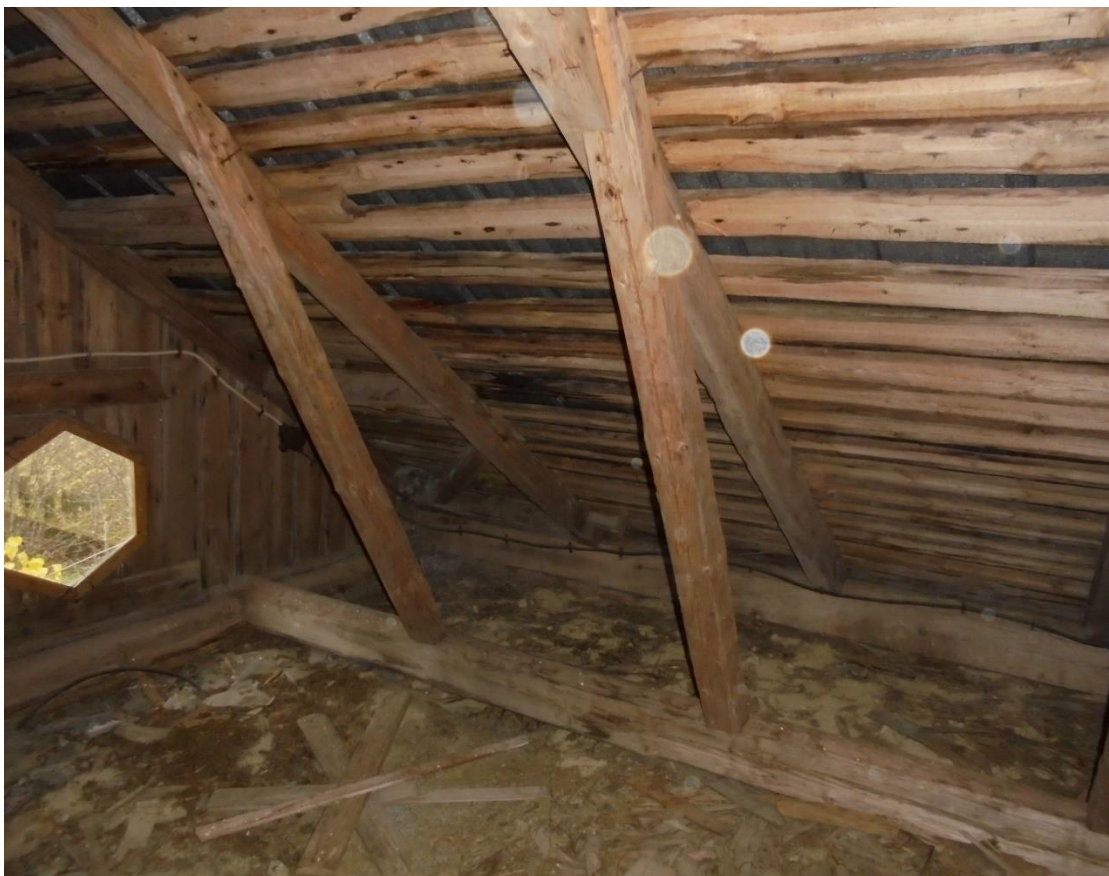
Kuva 37 Vinosuuntainen tukirakenne on kontin ja kypälän tilalla.
