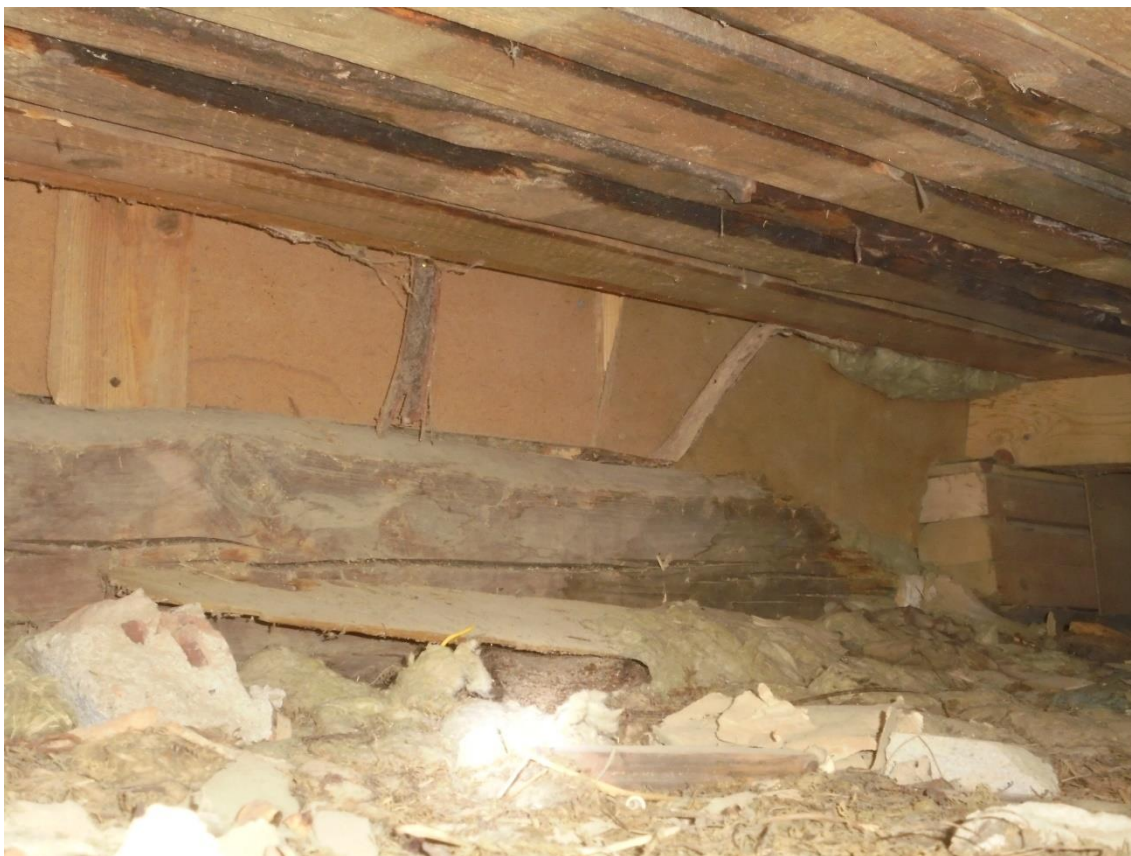
Kuva 15 Tupakeittiön alimpiin hirsikertoihin on tehty ns. insinöörikengitys eli hirttä on korvattu villalla ja pystyrungolla. Osittain lahonneita hirsiiä on jätetty paikoilleen. Vanhat lahovauriot alimmissa hirsikerroissa eivät aiheuta rakenteellisia ongelmia.
