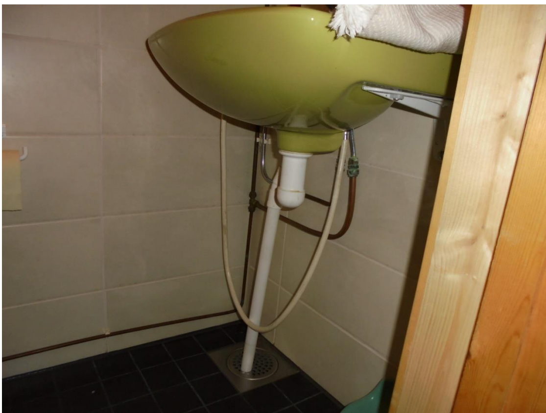
Kuva 54 Eteläpäädyn vessan kosteusvaurio oli aiheutunut ilmeisesti jäätyneestä lattiakaivosta johtuen.
