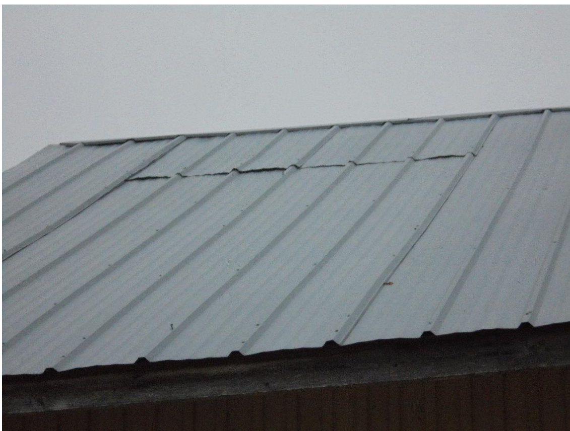
Kuva 38 Vesikate on hyvässä kunnossa, mutta kiinnitysnaulat kannattaa vaihtaa kateruuveihin.
