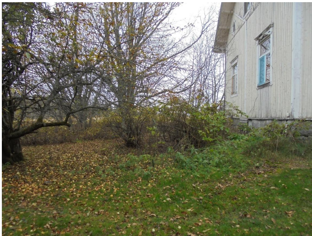
Kuva 2 Etelän puoleisessa päädyssä maanpinta kallistaa oikeaan suuntaan eli rakennuksesta poispäin.
