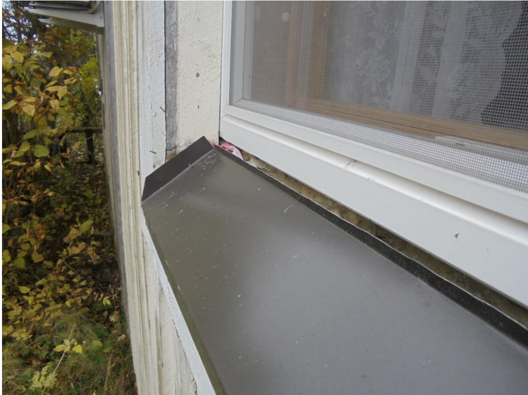
Kuva 41 Osa ikkunoiden pellityksistä on liikahtanut pois paikoiltaan.
