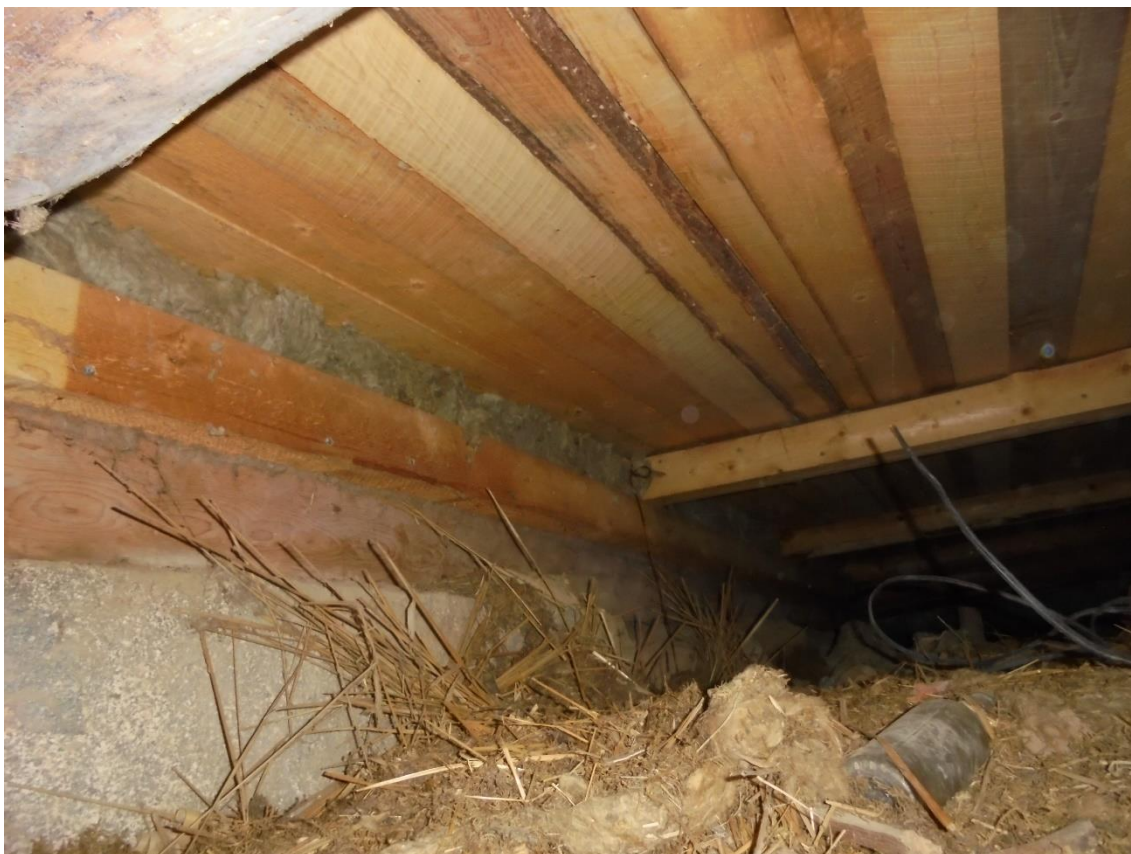
Kuva 26 Ryömintätilan pohja on täynnä vanhaa lämmöneristettä.
