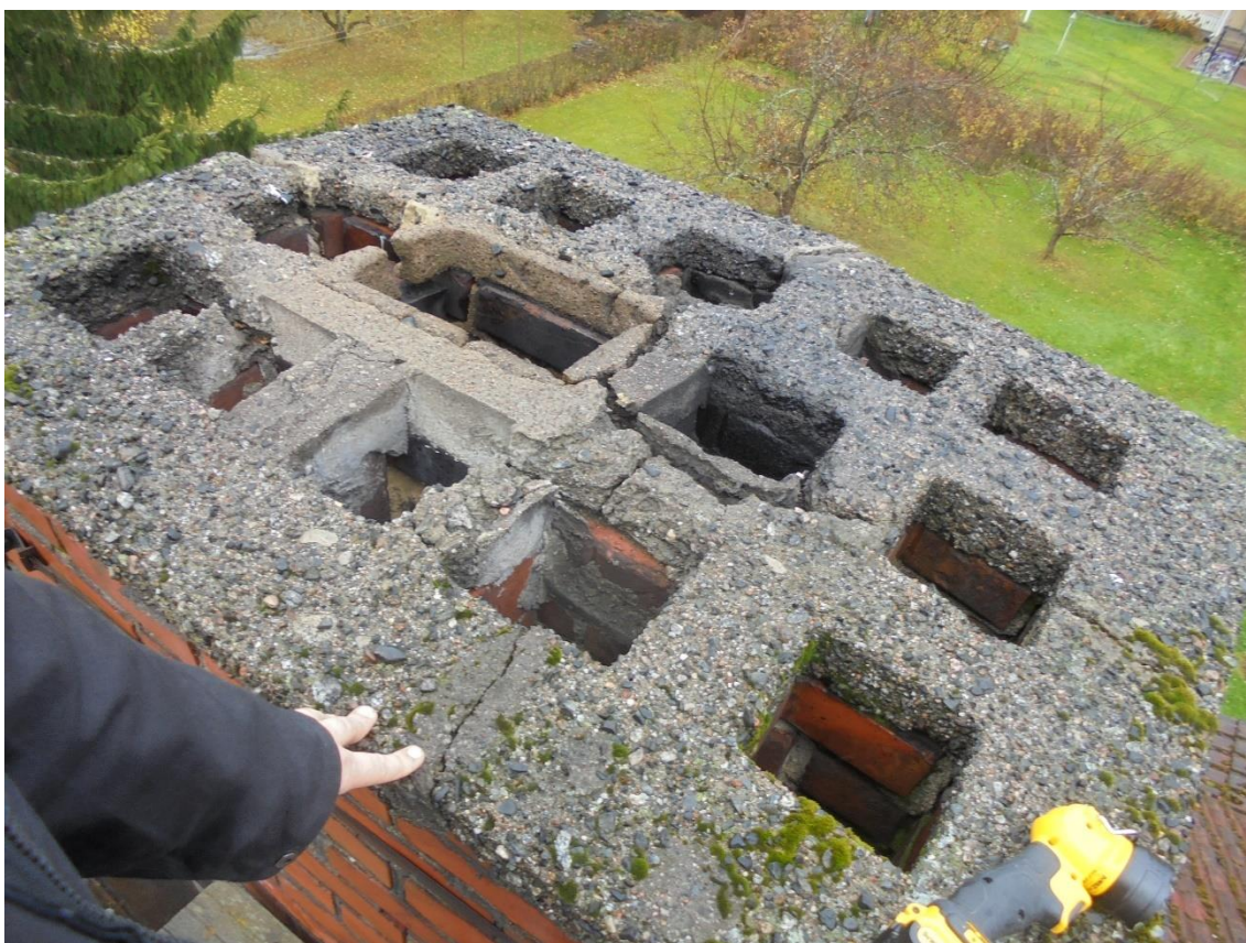
Kuva 39 Hormeja on yhteensä 14 kappaletta. Hormin päällä oleva suojavaalu on uusittava.
