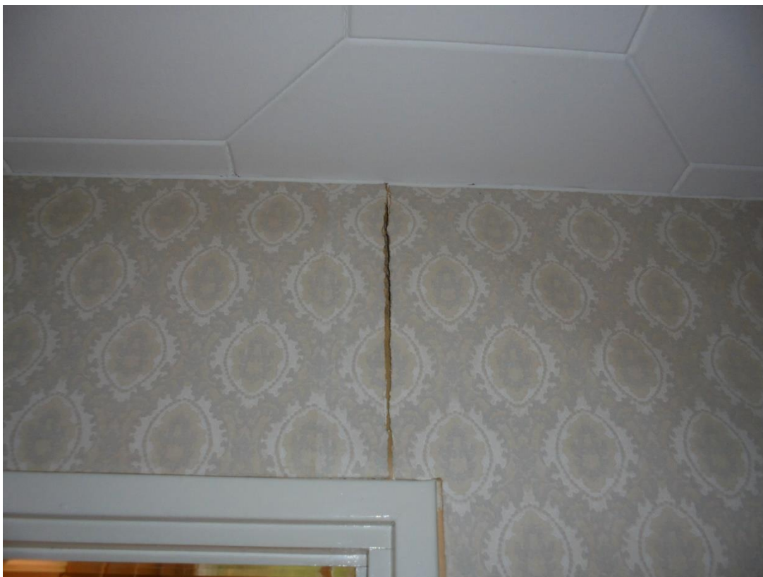
Kuva 43 Pinkopahvin repeäminen ei johdu rakennuksen liikkumisesta, vaan pinkopahvin kuivumisesta ilmankosteuden muuttuessa. Havaitut halkeamat eivät johdu rakenteiden liikkumisesta.
