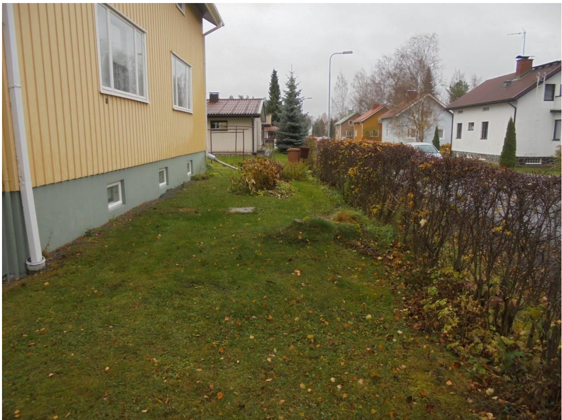
Kuva 2 Kadunvarsijulkisivun yhteydessä olevassa etelänurkassa on maanpinnan kallistukset rakennusta kohti, jolloin maanpinta ohjaa pieneltä alueelta sadevettä rakennuksen suuntaan.
