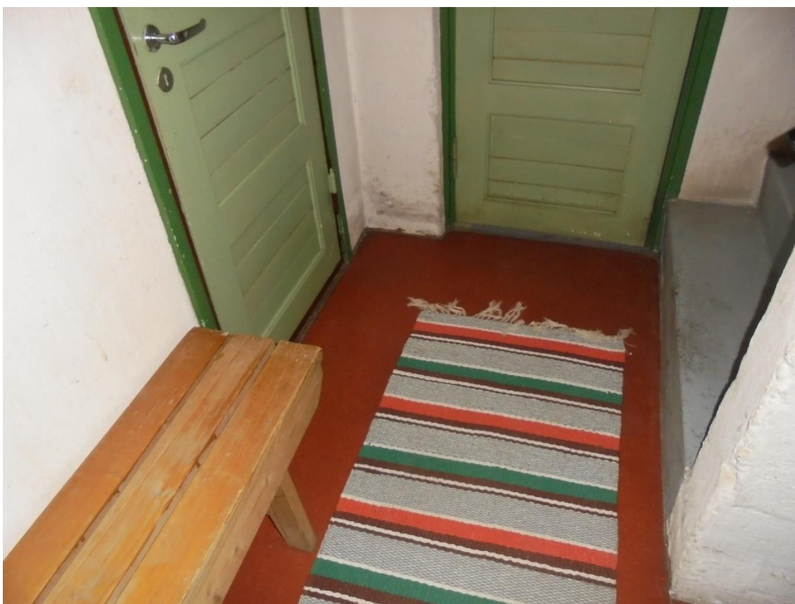
Kuva 13 Osassa kellarin latioissa on muovi- tai linoleummattoa, joka on poistettava. Matto estää lattiarakenteen kuivumisen, jolloin sen alle tiivistyy kosteutta. Kosteus vaurioittaa tiivistä pintarakennetta ja saattaa aiheuttaa mikrobi- ja bakteerikasvustoja.
