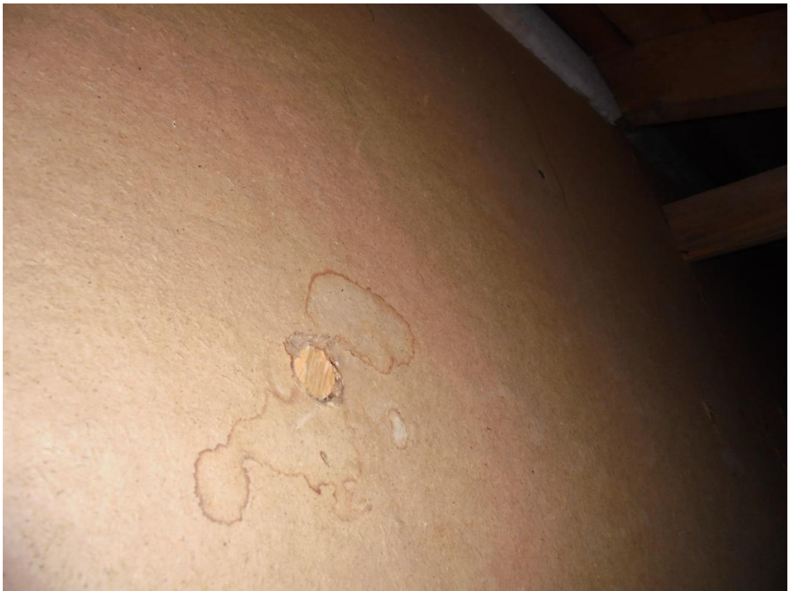
Kuva 23 Ureavaahtoreikä yläkerran kadunvarsijulkisivun puoleisessa sivuvintissä.
