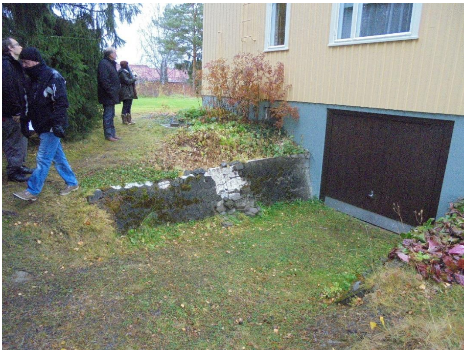
Kuva 5 Länsinurkalla maanpinta kallistaa loivasti rakennuksesta poispäin, mutta vesi kulkeutuu autotallin luiskaa pitkin kohti rakennusta.
