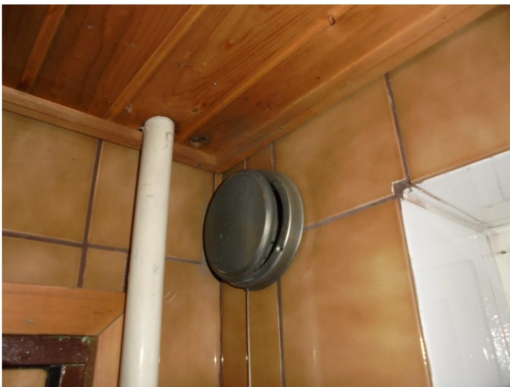
Kuva 14 Poistoilmaventtiili savupiipun ilmahormiin. Tuloilmaventtiilit sijaitsevat ulkoseinissä. Poistoilmaventtiilin tilalle voidaan asentaa poistoilmapuhallin.
