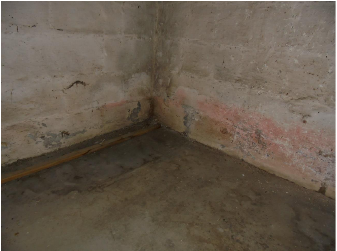
Kuva 25 Roskavalu on ohut ja yleensä raudoittamaton. Roskavalulle on ominaista runsas halkeilu, sillä sen alla oleva hiekkatäyttö painuu yleensä epätasaisesti ja tällöin raudoittamaton betoni halkeaa.
