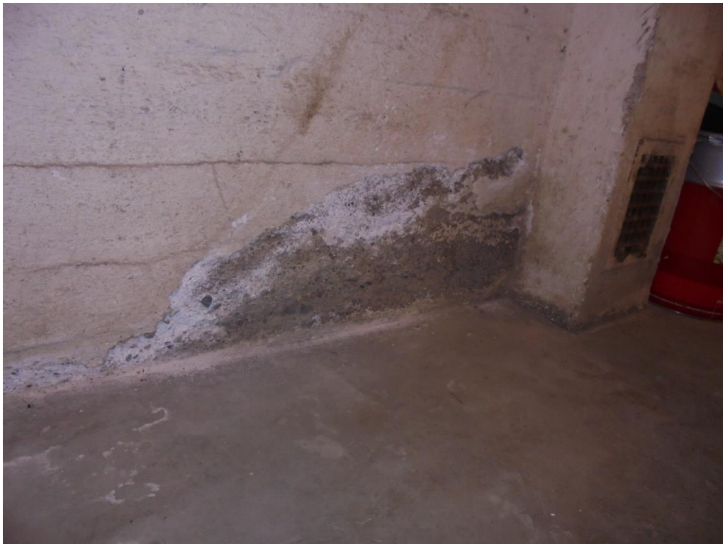
Kuva 17 Seinien alaosien pintakerrosten irtoaminen on myös tavallinen kosteuden merkki. Kellarissa tulee olemaan kunnostamisen ja salaojittamisen jälkeen edelleen kosteutta, sillä vaikka uusien lattioiden alle tehtäisiinkin toimiva kapillaarikatko, niin perusmuurien alle ei ole mahdollista kapillaarikatkoa tehdä.
