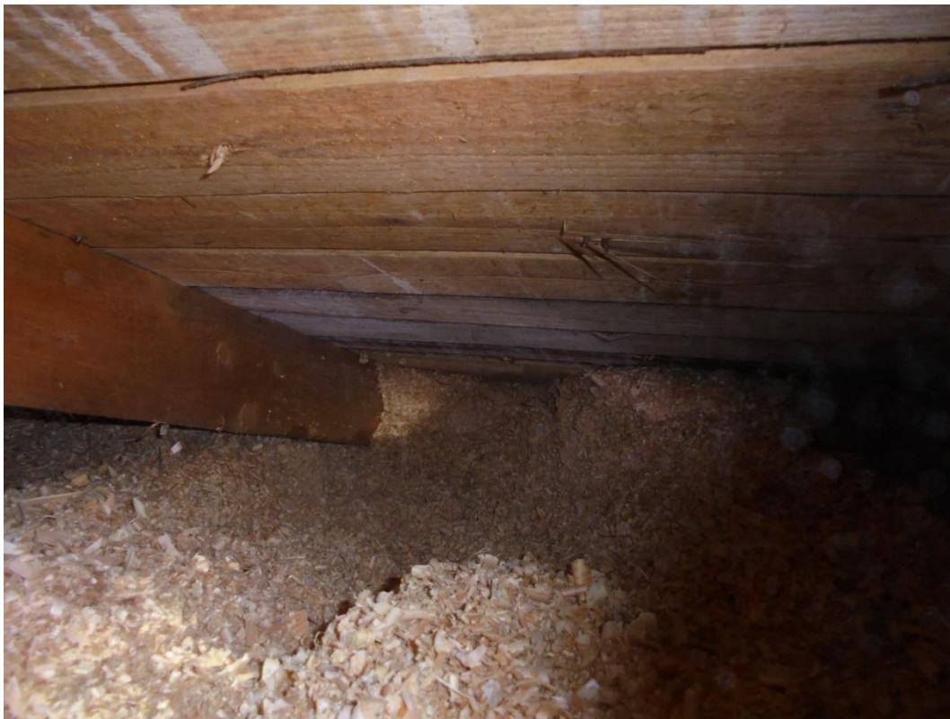
Kuva 31 ...ja yläpäistään auki kylmään yläkolmioon. Rakenteista ei havaittu vaurioita riskirakenteesta huolimatta, kun lämmöneristeitä siirrettiin sivuun.
