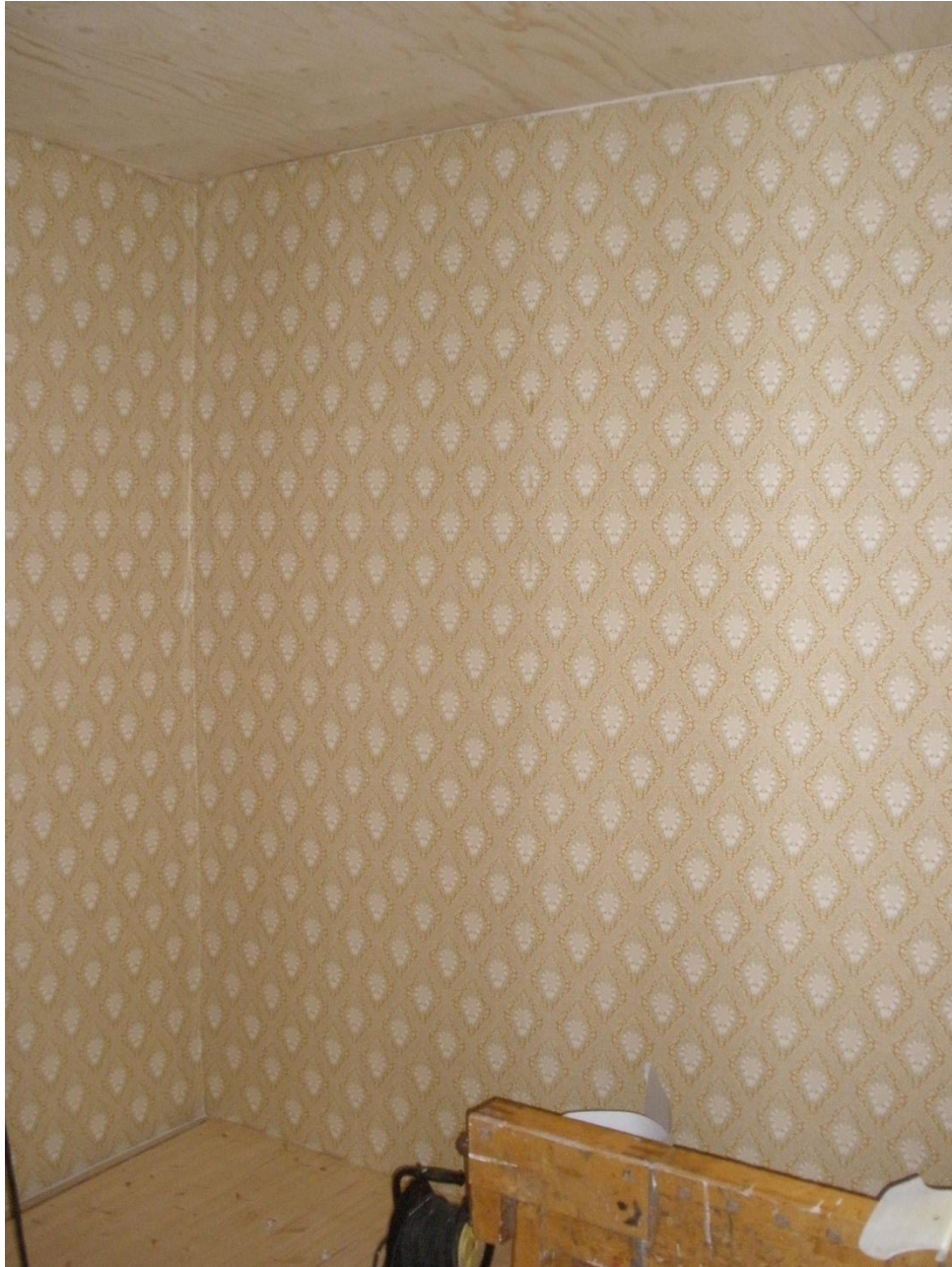
Kuva 28 Levysaummat tai naulankannat eivät loista valmiin pinnan läpi.
