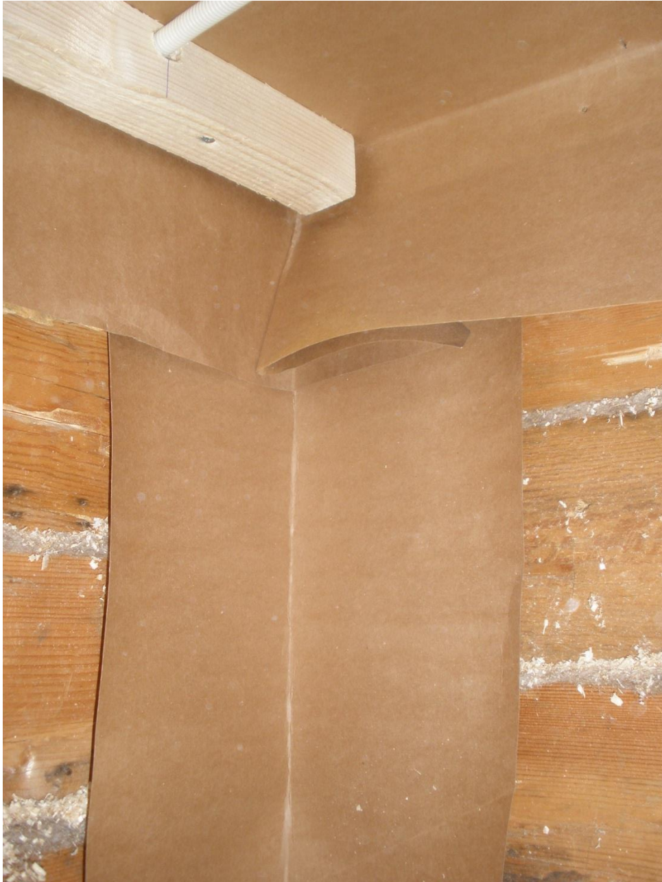
Kuva 5 Nurkat ovat lämpötalouden suhteen kriittinen osa, joten ne paperoidaan lattiasta kattoon asti. Nurkkien paperointi limitetään mahdollisten ylä- ja alapohjan paperointien kanssa riittävästi, jotta vältetään teipin käytöltä.
