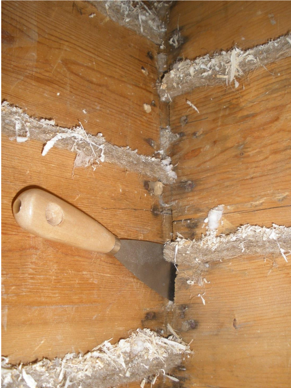
Kuva 2 Hirsien väliset varaukset, salvokset ja raot tilkitään pellavariveellä. Pullottavat riveet sekä naulat poistetaan. Mahdolliset ovi-, ikkuna-, jalka- ja kattolistat numeroidaan ja puretaan ehjänä. Lopuksi nämä palautetaan takaisin paikoilleen.
