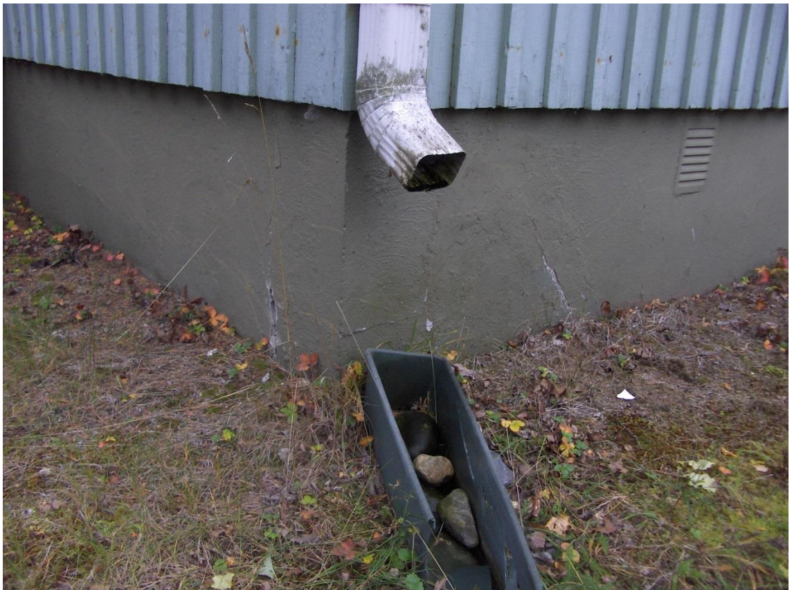
Kuva 7 Syöksytorvilta sadevesi valuu salaojiin ja kastelee tarpeettomasti perustuksia.
