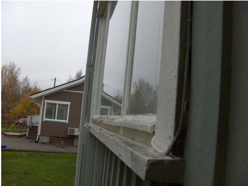
Kuva 31 Ikkunoiden alla on puinen tippanokka/vesilauta.
