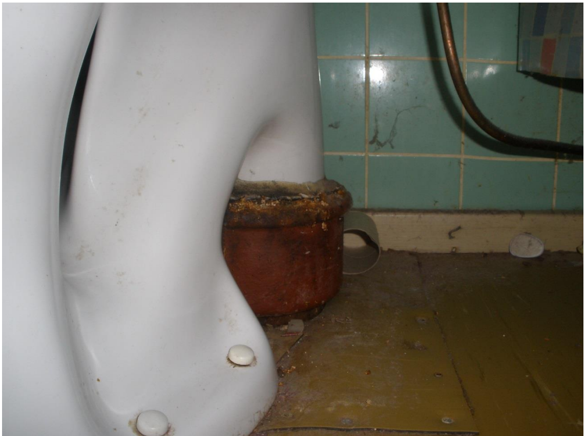
Kuva 21 Metalliset viemäri- ja vesiputket hikoilevat eli kondensoivat.
