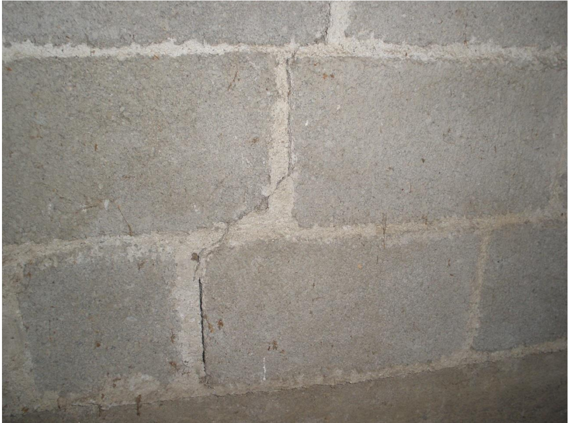
Kuva 10 Tiilet eivät ole liikkuneet halkeaman kohdalla eli painuminen on ollut vähäistä.
