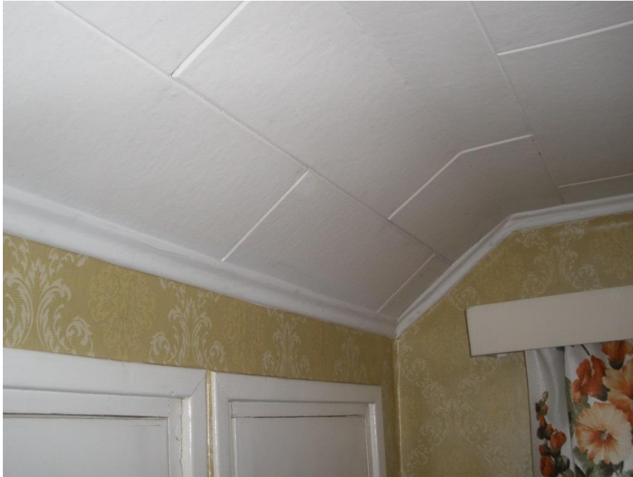
Kuva 23 Eristetyt vinolappeet ovat tyypillinen riskirakenne.
