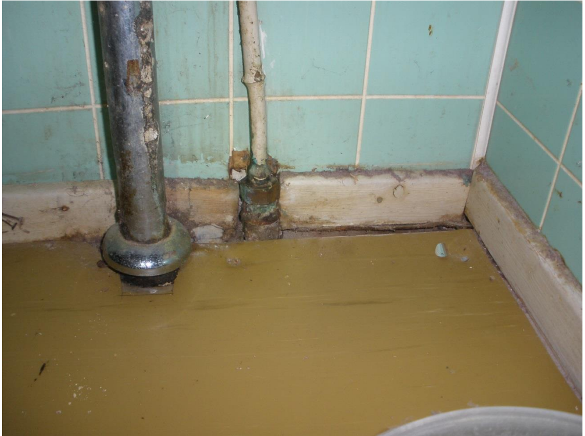
Kuva 16 Vessasta löytyy pistemäinen lahovaurio lattianrajasta.
