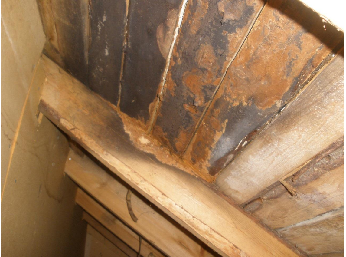
Kuva 25 Vanha sienikasvusto on kuivunut, joten vaurio on pysähtynyt.
