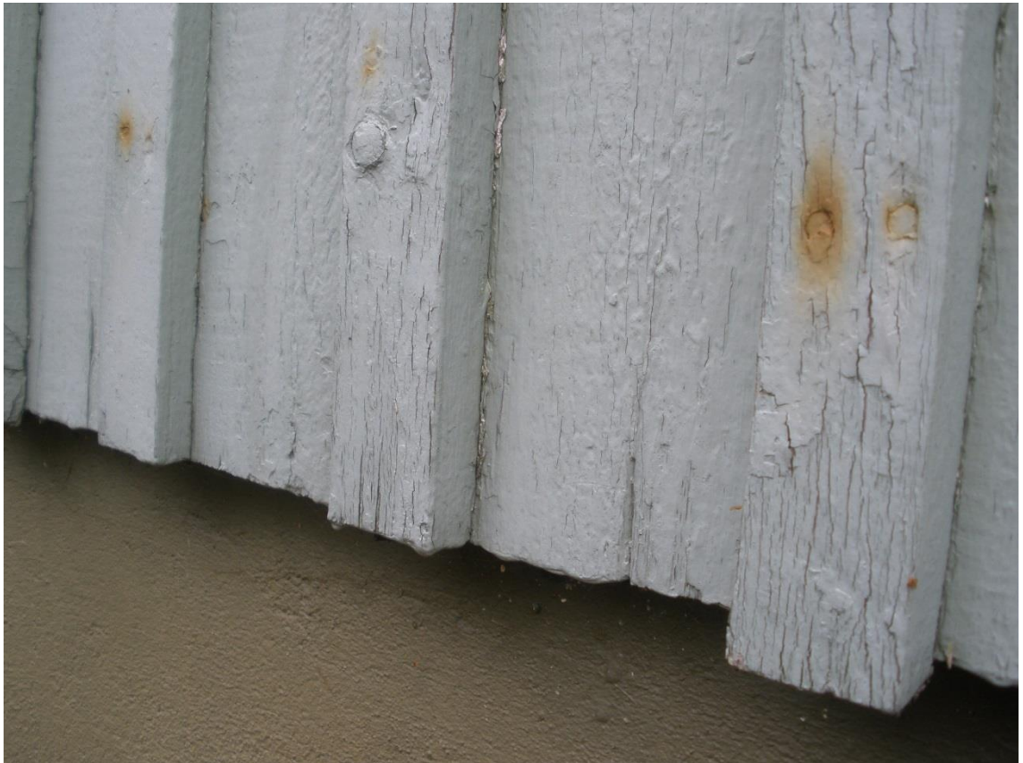
Kuva 18 Ulkovuoren alahelmassa on alkavaa halkeilua, mutta lahoa ei ole.
