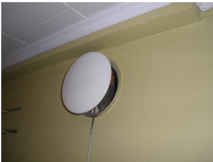
Kuva 42 Yläkerran poistoilma räppänä johtaa savupiipun ilmahormiin.
