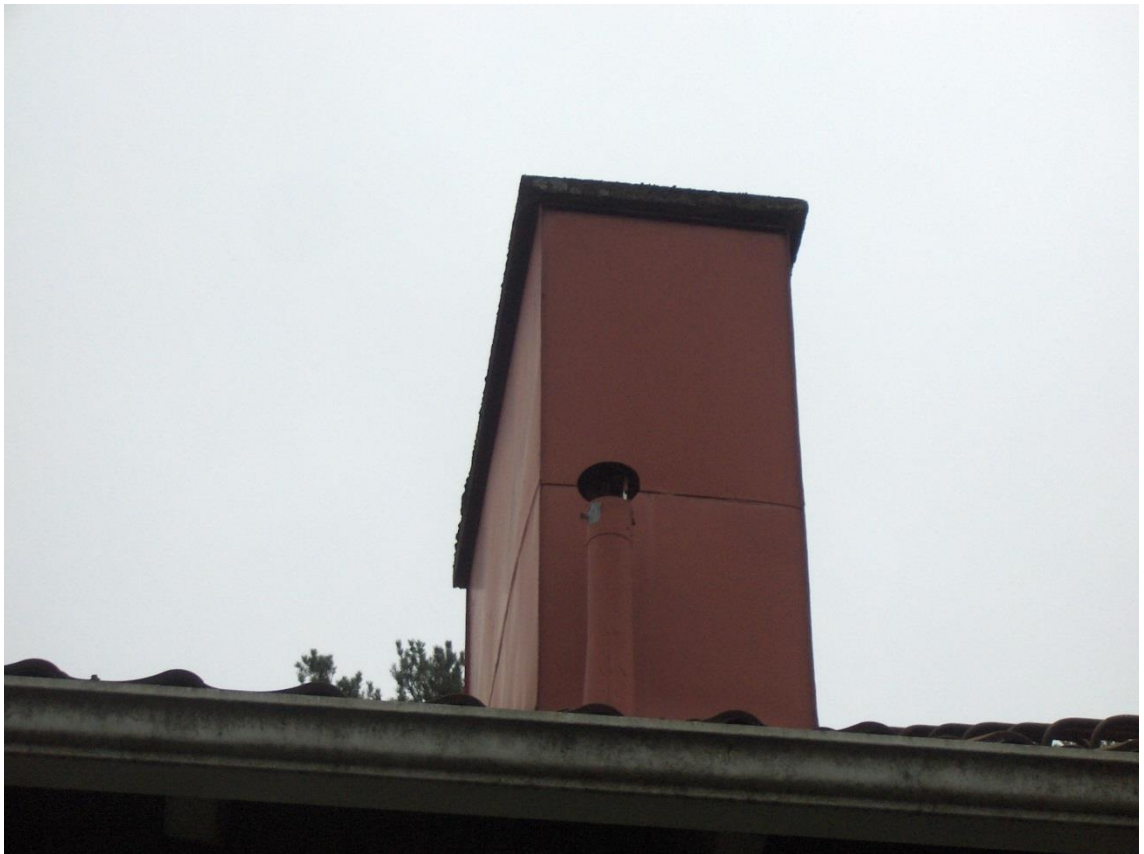
Kuva 34 Kattoremontin yhteydessä savupiippu on pellitetty. Sadehattu kannattaa lisätä.
