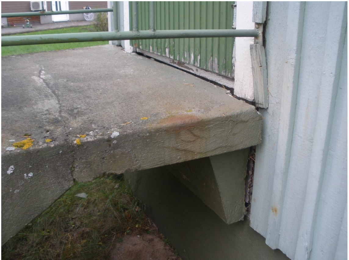
Kuva 15 Puuta vasten valetut betonirakenteet ovat tyypillisiä lahovauriopaikkoja.
