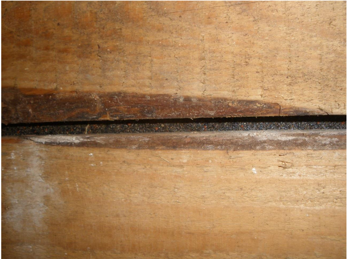
Kuva 26 Huopakatto on nähtävissä lautojen raoista.
