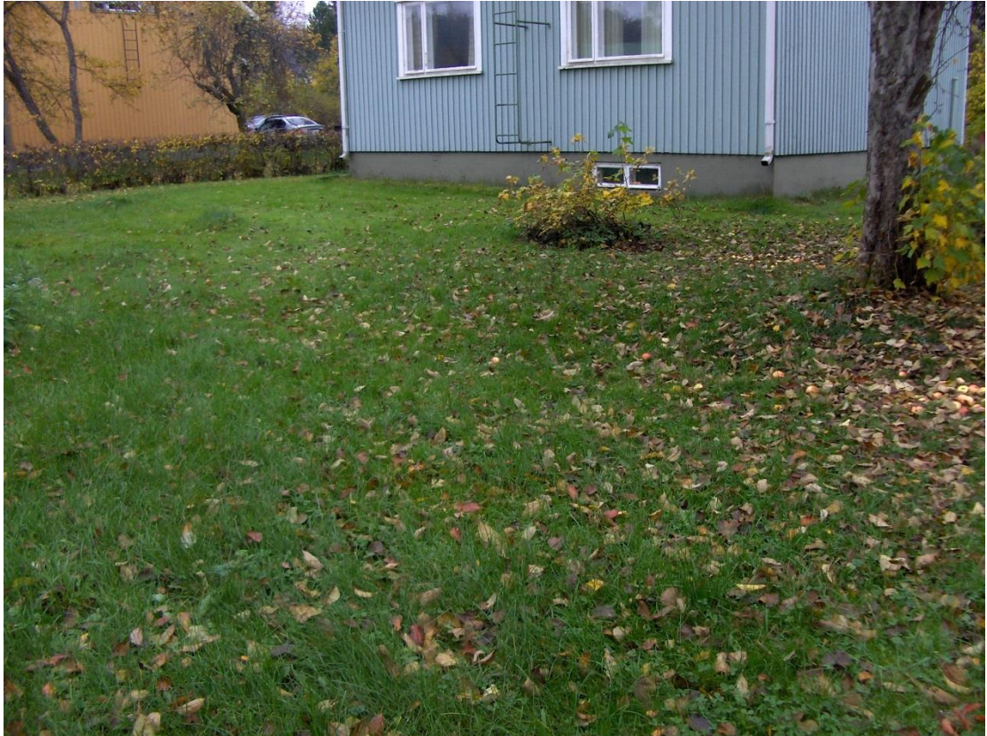
Kuva 5 Lännen puoleisella julkisivulla kallistukset ovat oikeaan suuntaan.
