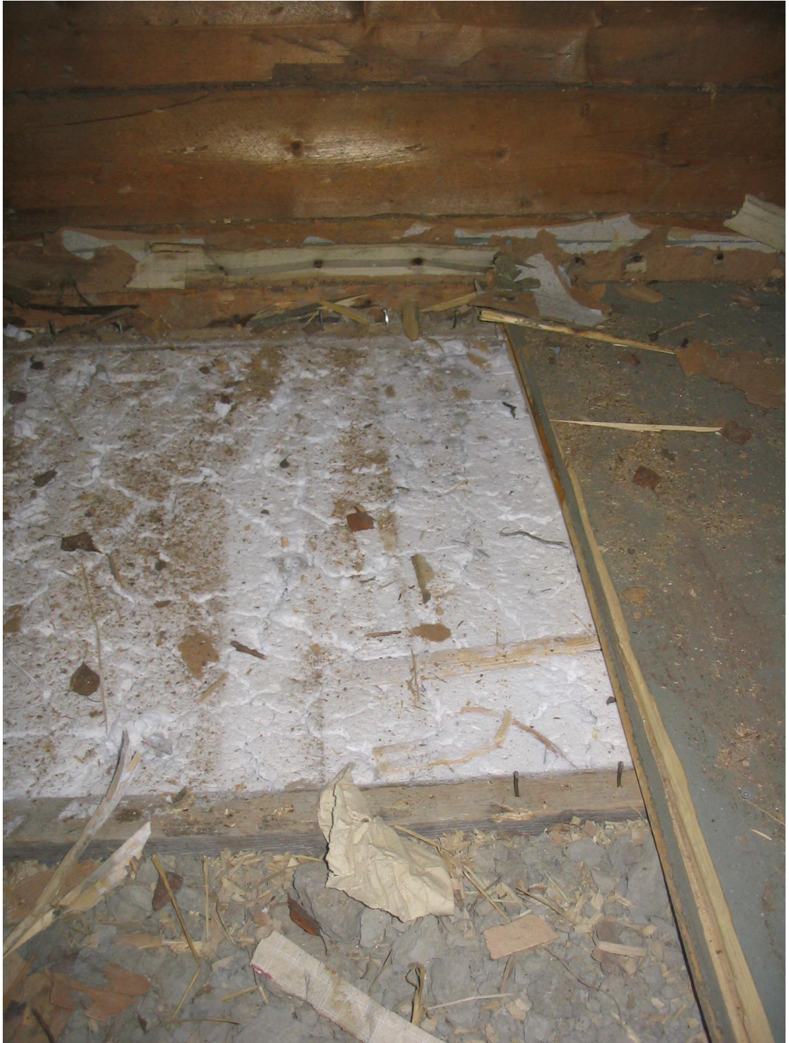
Kuva 10 Lattiaremontin yhteydessä paljastui ureavaahdolla suoritettu lisälämmöneristys. Alkuperäisen lämmöneristeen painuessa on muodostunut lattian alle tyhjä tila, johon on puhallettu ureavaahto ulkoseinien lävitse porattujen reikien kautta.
