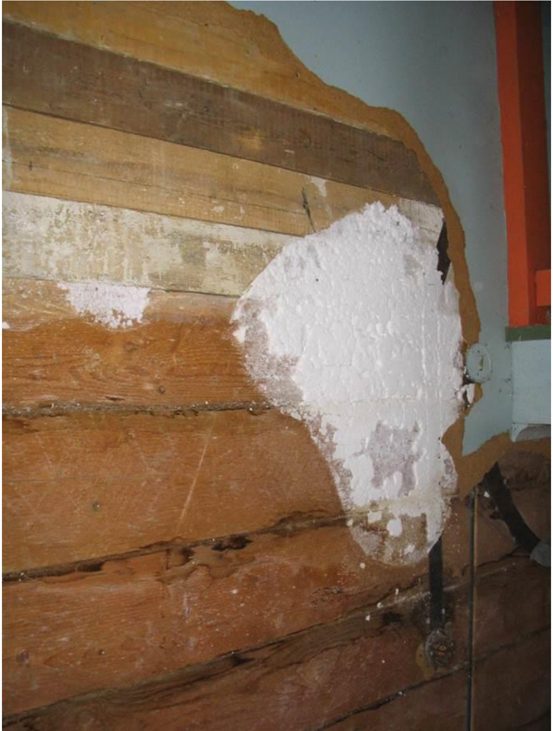
Kuva 4 Hirsirakennuksen sisäseinät on levytetty 3mm kovalevyllä. Kovalevyn ja hirren väliin on puhallettu pistemäisesti ureavaahtoa. Ureavaahto muistuttaa erehdyttävästi lahottajasienen kasvustoa.
