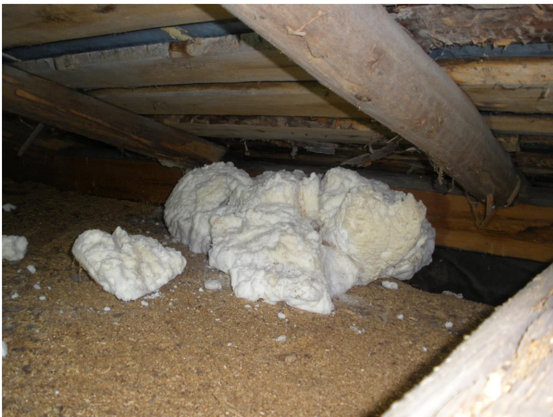
Kuva 5 Purueristeiseen ulkoseinän alaosaan on asennettu ureavaahtoa, joka on rakenteen ilmavuotoa pitkin kulkeutunut yläpohjaan asti.
