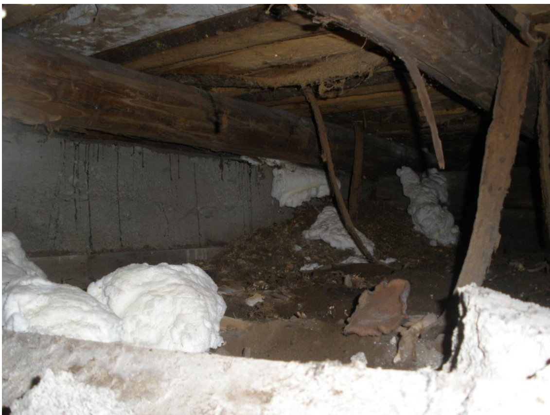
Kuva 11 Seinän lisälämmöneristämisen yhteydessä on ureavaahtoa purkautunut ryömintätilaan asti.
