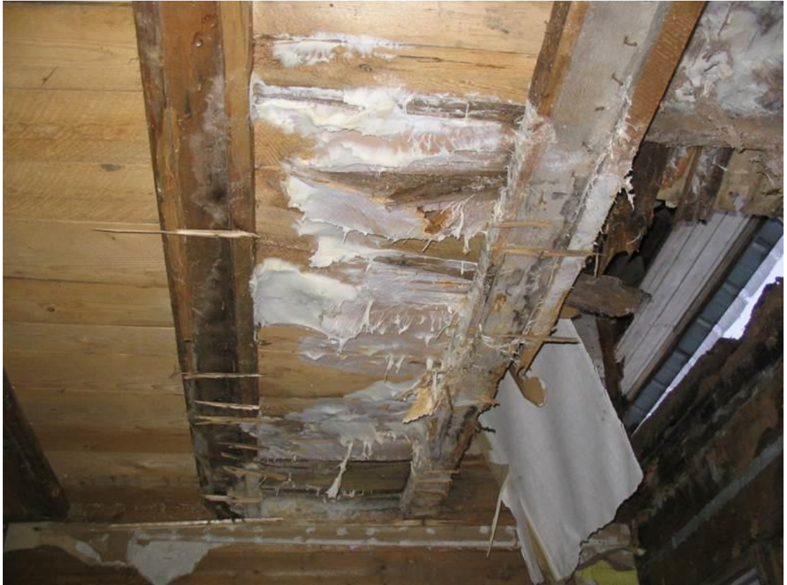
Kuva 3 Kuvassa on lahottajasienen kasvustoa välipohjassa. Valkoinen kasvusto näyttää erehdyttävän paljon ureavaahdolta, mutta rakenne on selvästi erilainen. Ureavaahto on haurasta ja herkästi hajoavaa, kun lahottajasienen kasvusto taas on nahkean elastista.
