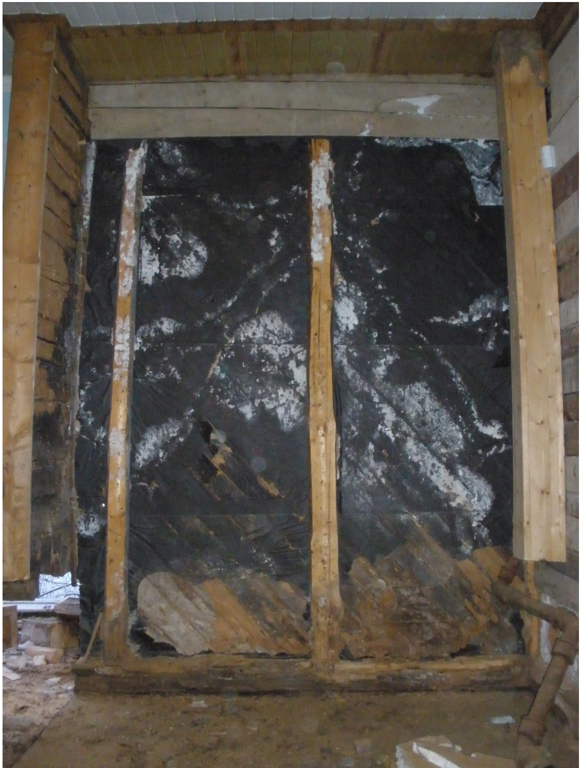
Kuva 8 Purueristeisen ja pystyrunkoisen seinän lahovauriot eivät ole aiheutuneet ureavaahdosta, vaan maanvaraisesta laatasta kapillaarisesti nousseesta kosteudesta. Ureavaahto ja sahanpurut on poistettu, mutta tervapahvissa on edelleen nähtävissä ureavaahdon valkoista väriä.
