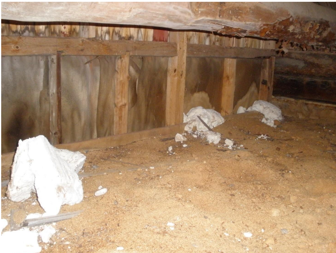
Kuva 6 Purueristeistä seinää on lisälämmöneristetty ureavaahdolla. Vaahtoa on kulkeutunut kylmälle vintille. Ulkoseinässä näkyvät kosteuden aiheuttamat valumajäljet eivät ole aiheutuneet ureavaahdosta, vaan seinään satavasta viistosateesta.
