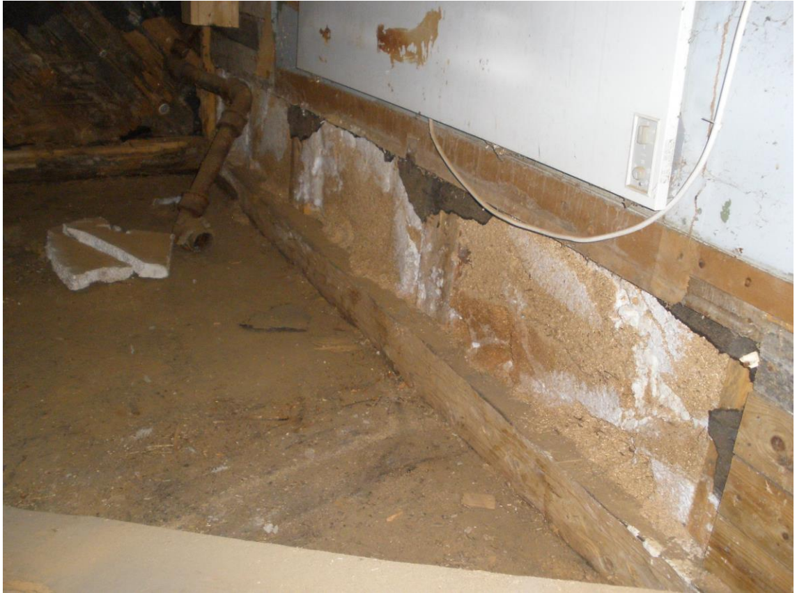
Kuva 7 Maanvaraisen laatan päällä ollut lattia on rakenteineen purettu pois, jolloin pystyrunkoisen ja purueristeisen seinän alaosa on tullut näkyviin. Purun seassa on runsaasti ureavaahtoa.
