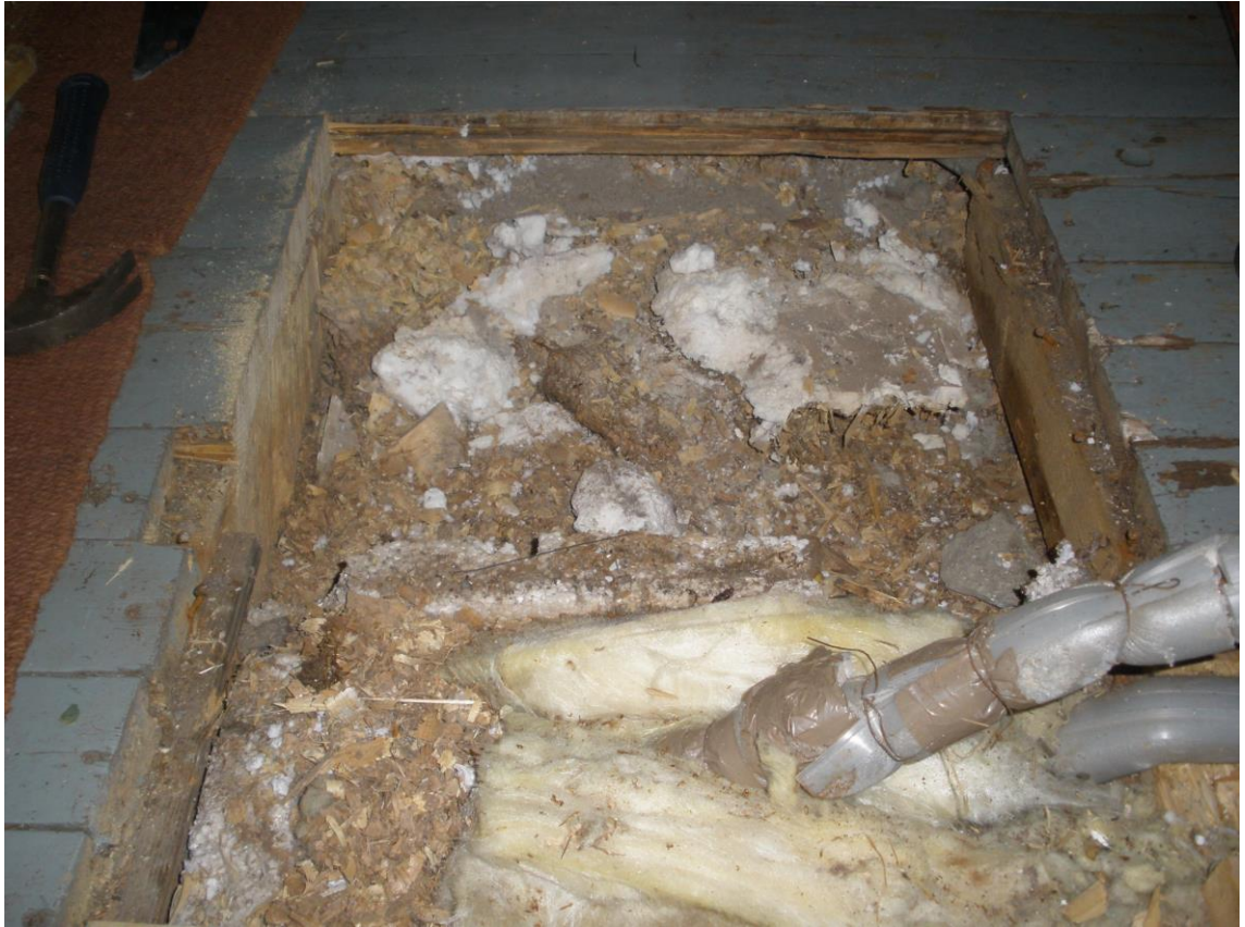
Kuva 9 Alapohjarakenteena on kuvan lattiassa tuulettuva alapohja eli rossipohja. Vesiputkien jäätymistä on yritetty estää lisälämmöneristämällä, joka on suoritettu ureavaahtoa asentamalla. Valkoinen vaaho lattiarakenteessa muistuttaa lahottajasienen kasvustoa.
