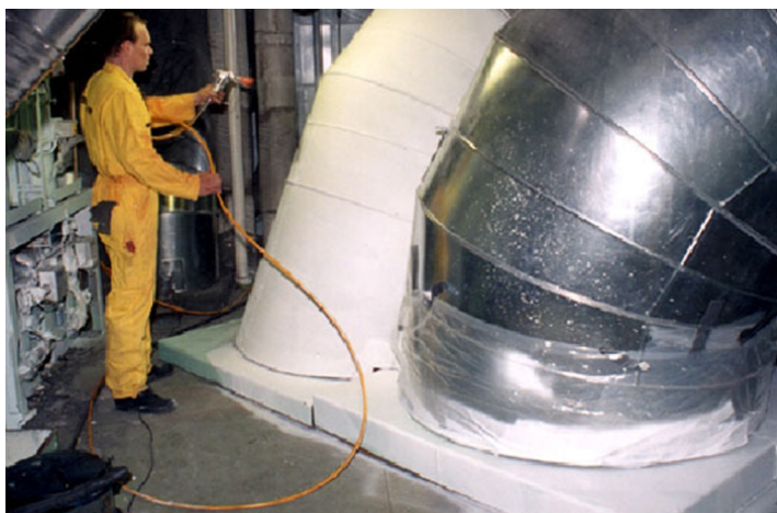
Ilmastointikanavien kondensio estetään Temp-Coat eristyksellä
