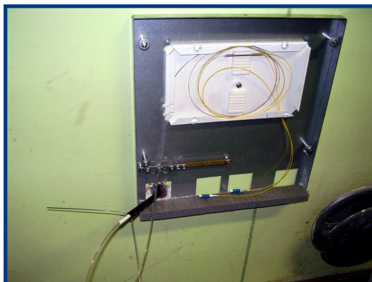
Kuidut kytketty liitosrasiaan
