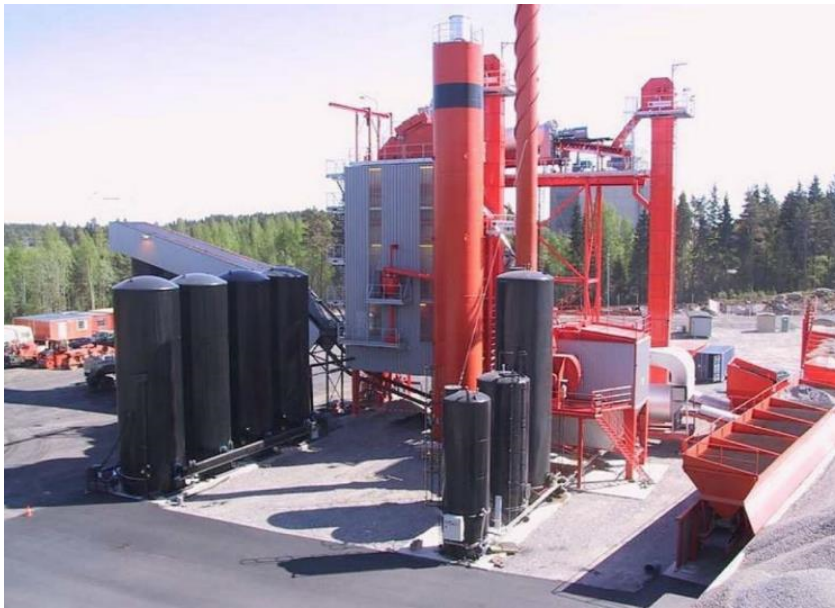
Turun asfalttiasema Benninghoven (TBA240), 2005, 240t/h
